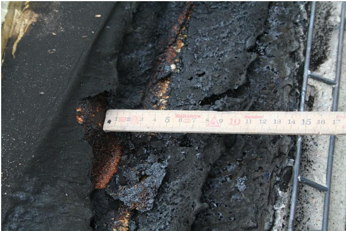
Bilde 7: Bildet viser 16cm innbrenning i PUR- skummet
