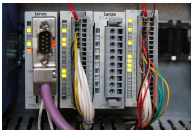
Figur 18: I/O modulen montert i styreskapet.
