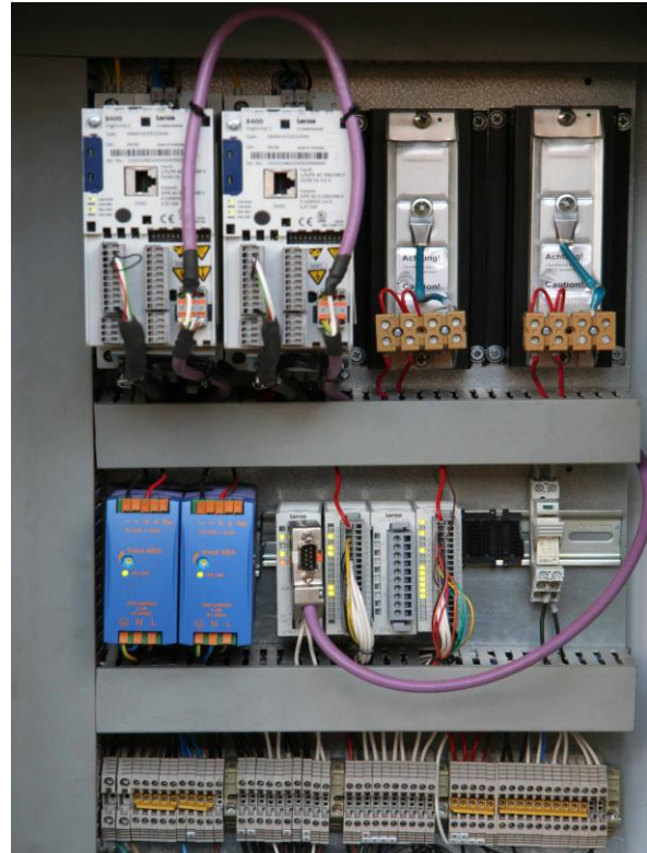
Figur 20: Styreskapet ferdig kopla.
