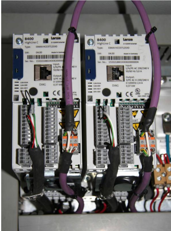
Figur 19: Frekvensomformarane montert i styreskap.
