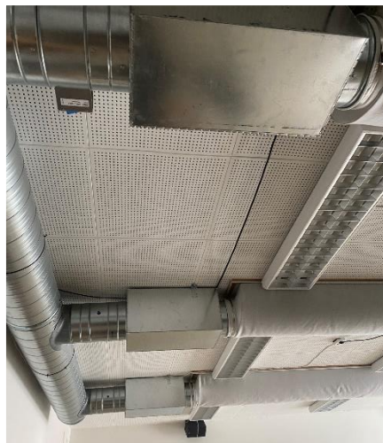
Bilde 38: Fungerende balansert ventilasjonssystem i musikkrom, privat foto.
