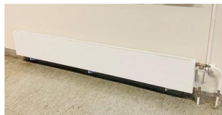
Bilde 46: Radiator i korridor som ikke er i bruk, privat foto
