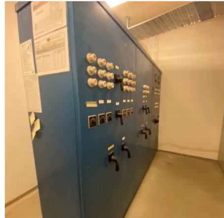
Bilde 31: Sikringsskap fremside, privat foto
