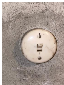
Bilde 27: Gamle brytere, denne lokalisert ved "bomberom" under administrasjonsfløy, privat foto
