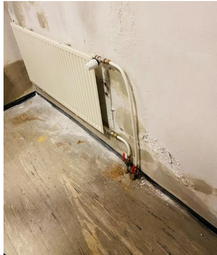
Bilde 112: Radiator i kjeller på toalett, i samme rom som knust vindu (se utsporing vinduer), ikke på – ellers fyrer de for fuglene. Privat foto
