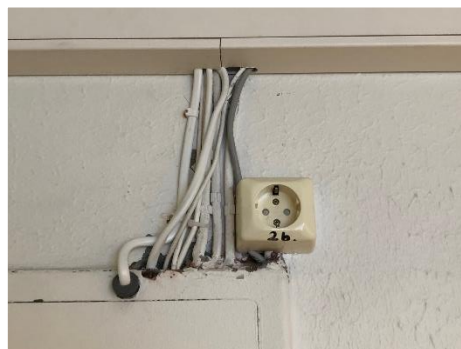
Bilde 34: Gamle ledninger, med nye tilskudd i trange hull og gjennomganger, privat foto
