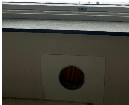
Bilde 39: Ventilasjonshull som er tettet i musikkrommet, privat foto.
