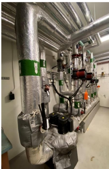
Bilde 44: Fjernvarmesystemet i kjeller, levert av Eviny, privat foto
