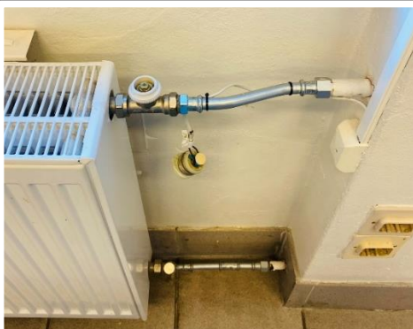
Bilde 47: Brukere har til vane å ødelegge radiatorregulatoren, privat foto
