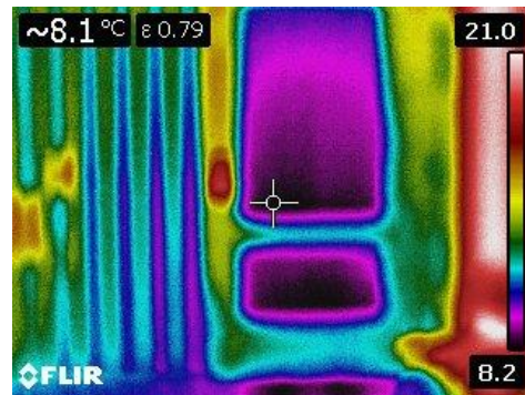
Bilde 115: Illustrert varmetap fra dør nordside med termografering. Privat foto
