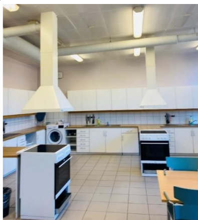
Bilde 41: Dårlig ventilering på kjøkkenet, privat foto
