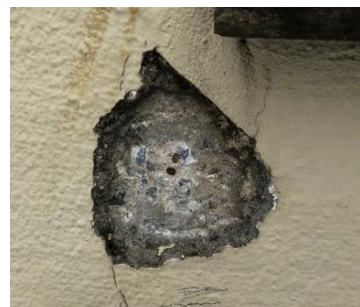
Bilde 5: Skade i yttervegg, privat foto
