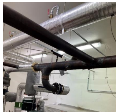
Bilde 8: Gamle rør uten isolasjon, privat foto
