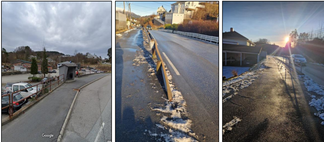
Figur 45 - Rekkverk ved busslomme har mye rust, autovern i dårlig stand, manglende rekkverk mot carport og parkering
