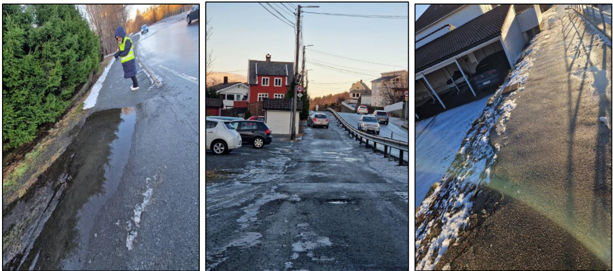
Figur 44 - Mye vann på fortau, slag hull og dårlig dekke, asfaltkant tydelig slitt og går i oppløsning
