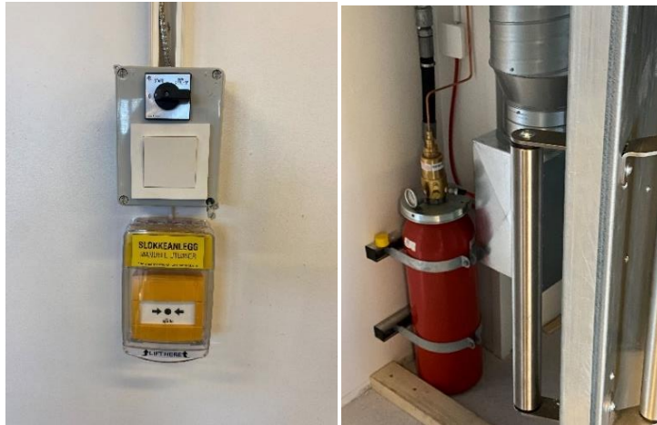
Figur 13 Manuelt slukkeanlegg og slukkeapparat
