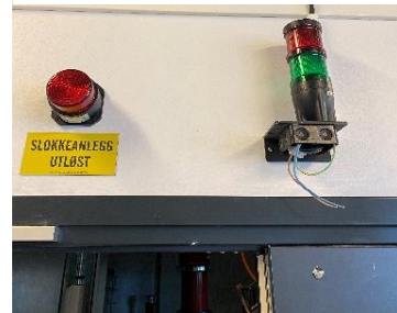
Figur 11 Slukkeanlegg og varsellamper
