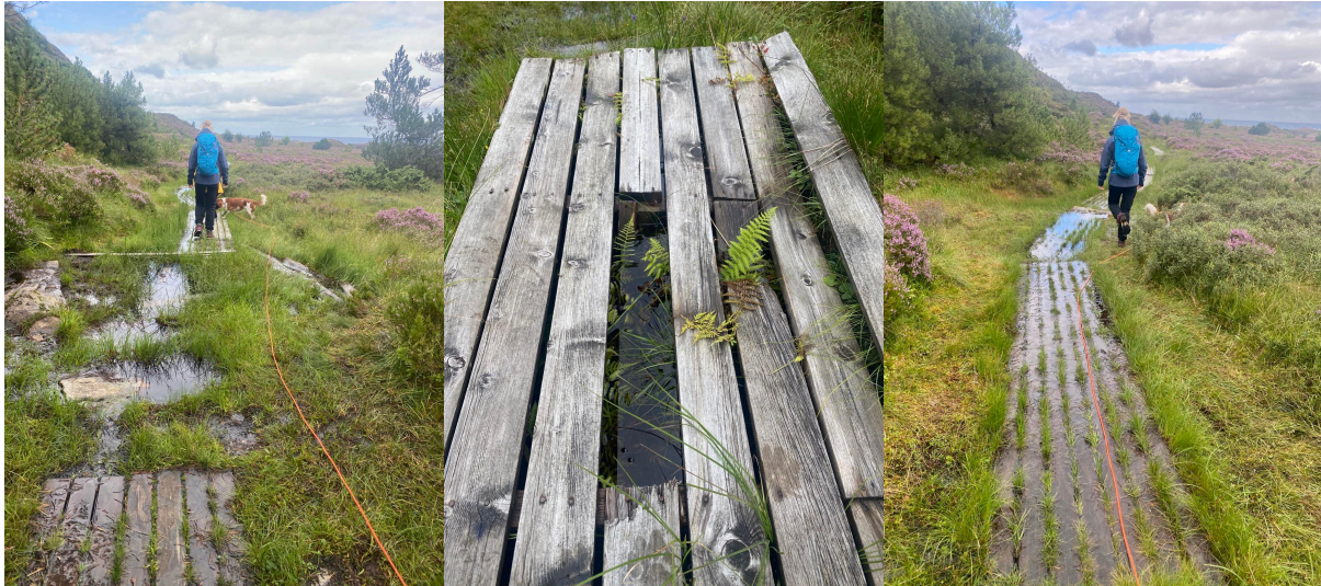
Figur 10: Slitasjeskader og overvann på klosterstien. Bilder tatt på synfaring 22.08.2022.
