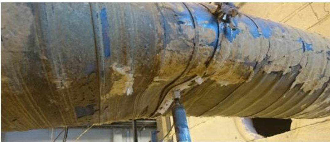
Figur 4-15 Kanalen var tydelig deformert etter endt forsøk. Bildet er tatt etter at isolasjonen ble fjernet, og er fra test 27.
