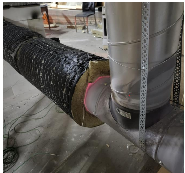
Figur 41: Gløding i enden av isolering (EI 60)
