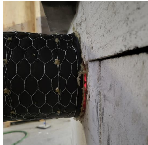
Figur 53: Det kan tydes glødende kanal under isoleringen.
