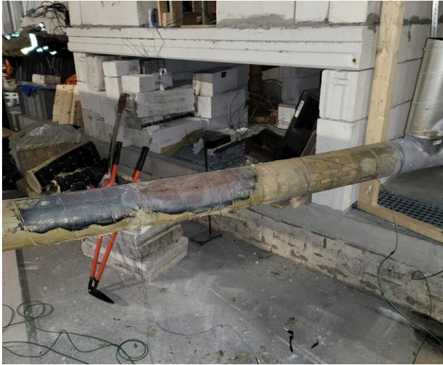
Figur 46: Kanaler i forsøk 1 etter brannisoleringen er tatt bort.
