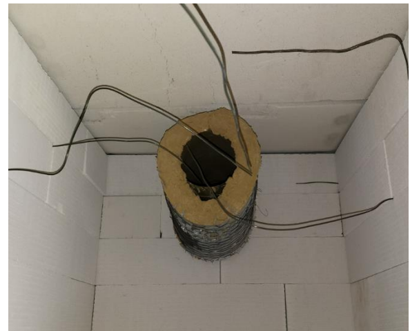
Figur 45: Kanal og brannisolering etter forsøk 1
