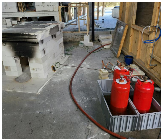
Figur 19: Oversiktsbilde av gasstanker
