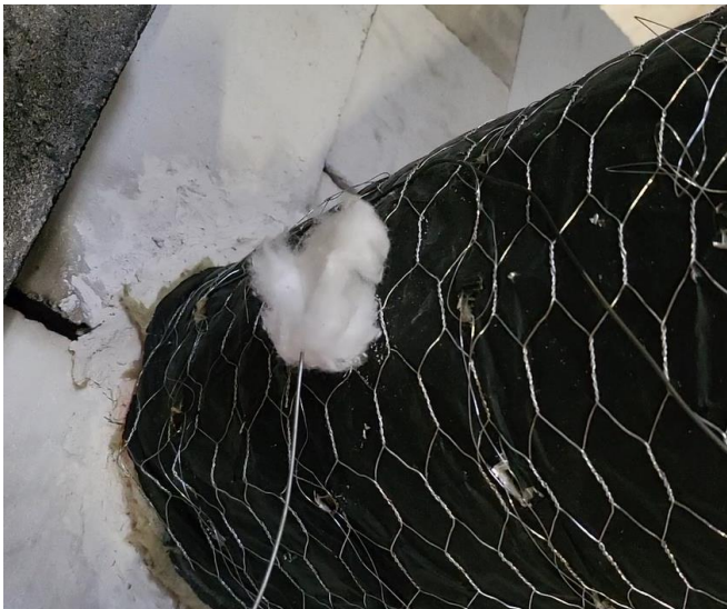
Figur 55: Bomulldott på EI 15 brannisolering
