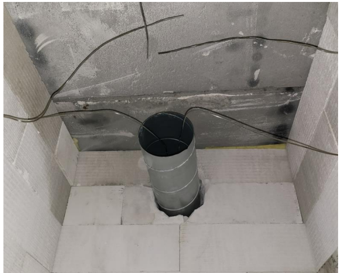
Figur 22: Innside av gjennomføring før branntetting.
