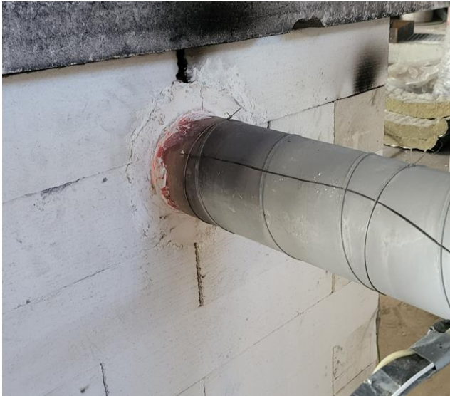
Figur 59: Gløding på kanal uten isolering.
