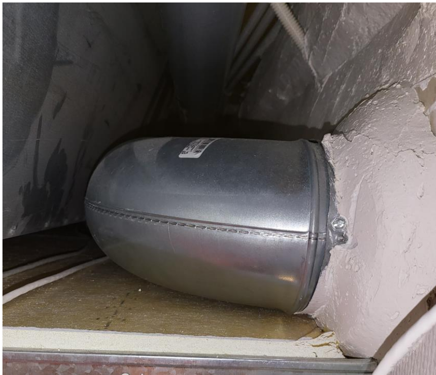
Figur 68: Eksempel på plassmangel hvor ventilasjonskanalen ligger tett på brennbare materialer.
