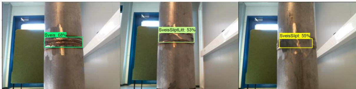
Figur 42- Bilder som viser de tre forskjellige tilstandene sveisen kan ha som er tatt hensyn til.
