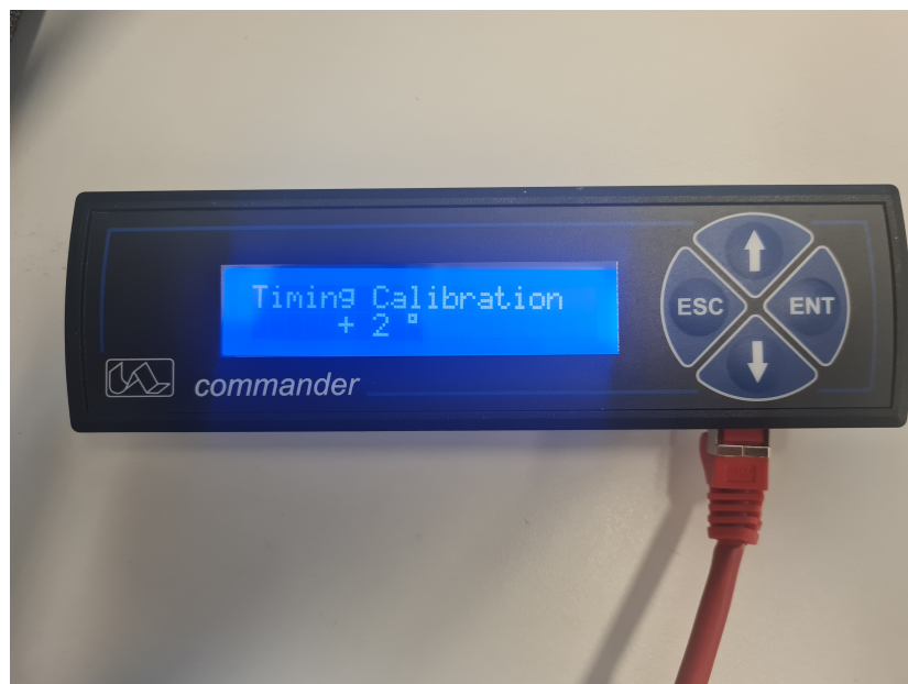
Figur C.5: Display som viser data på den gamle omformaren. Bilete viser korleis ein kalibrerer nullgjennomgangen for synkronisering med pulstog.
