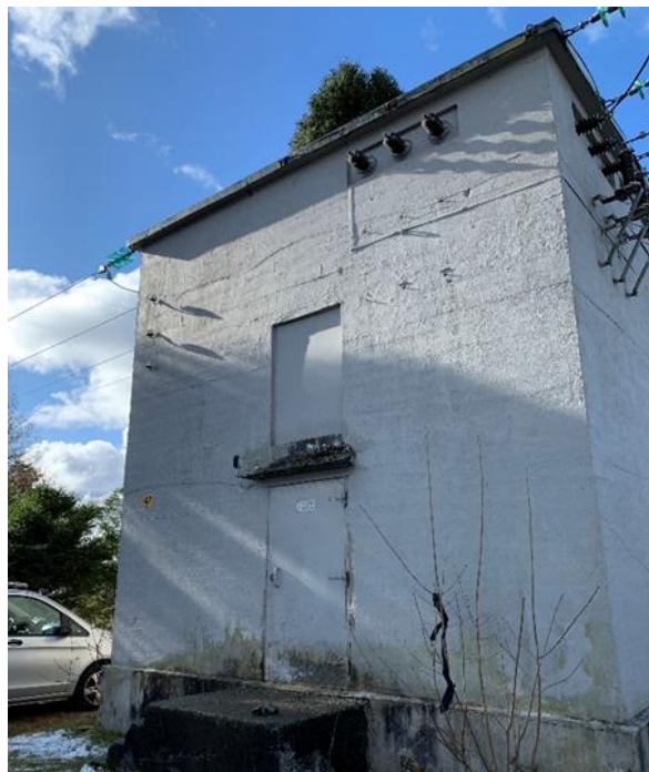
Bilde 5-1: Bilde av fjernstyrt koblingsstasjon på Askøy (fra befaring)
