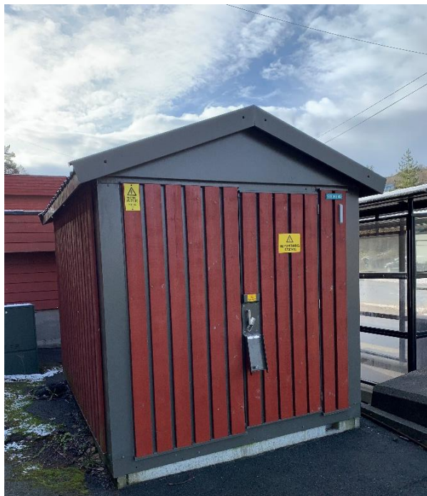
Bilde 5-2: Bilde av nettstasjon med fjernstyring på Askøy (fra befaring)
