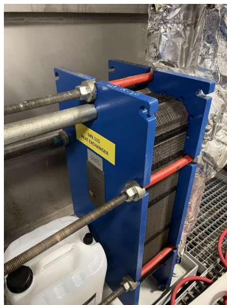
Figur 5: En av platevarme-vekslerne med kapasitet på 230,1 kW
