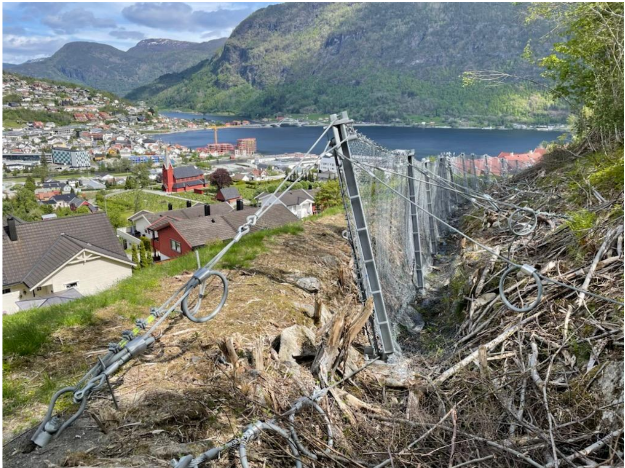
Figur 26: Bilde av grøften og fanggjerdet ovenfor bebyggelsen i Stedje, Sogndal kommune (Foto: Yngvild Skjeldnes).
