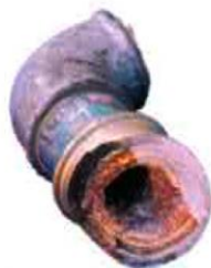
Vannrør med humus, oksider og kalk
