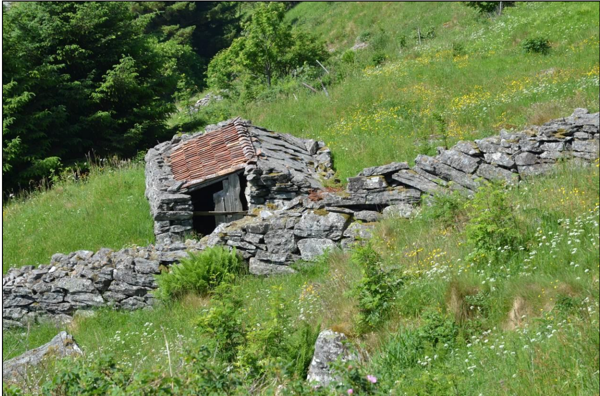
Fig. 45. Et av torvhusene til 48/1 er plassert i nedre del av lisisiden. Murene er intakte. Bygningen er en viktig del av helheten og bør fortsatt holdes ved like. Foto: Leif Hauge.
