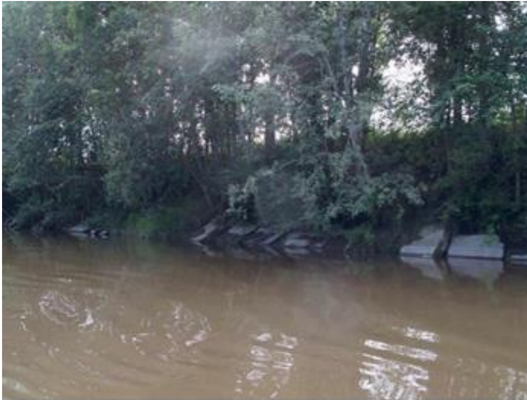
Figur 9. Det er plassert betongelementer flere steder der elva graver i yttersvinger for å hindre at den meandrerer seg inn i arealer med jordbruk. Foto: Kjell Magne Olsen.
