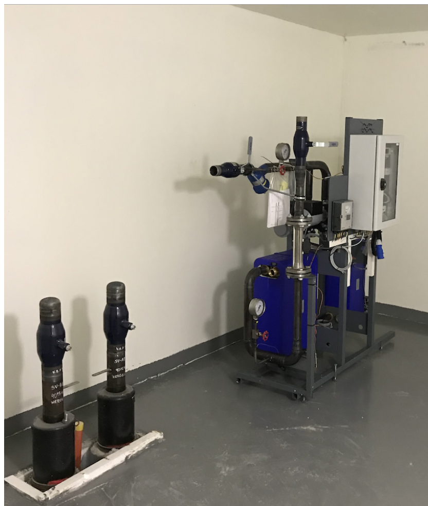
Figur 5: Kundesentral, Foto fått fra BKK Varme. Tillatelse til bruk i oppgaven.
