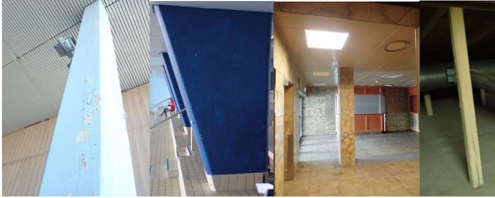
Figure 28: Betongsøyle med bassengdelen i Sentralbadet. Tilsendt fra Asplan Viaks befaring i 2019.
