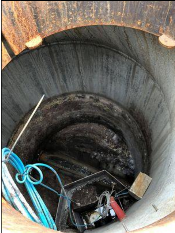
Figur 25 Viser kum med V – overløp utføre reinseanlegget, punkt 1
