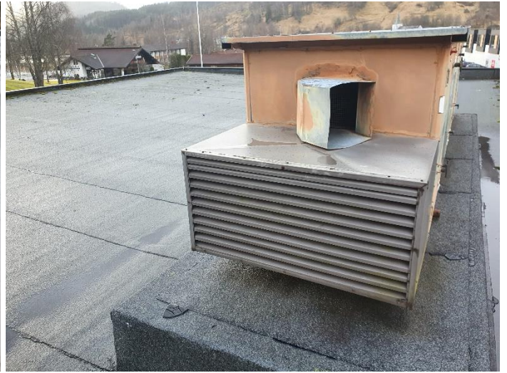
Figur 608 Ventilasjonsaggregat på tak
