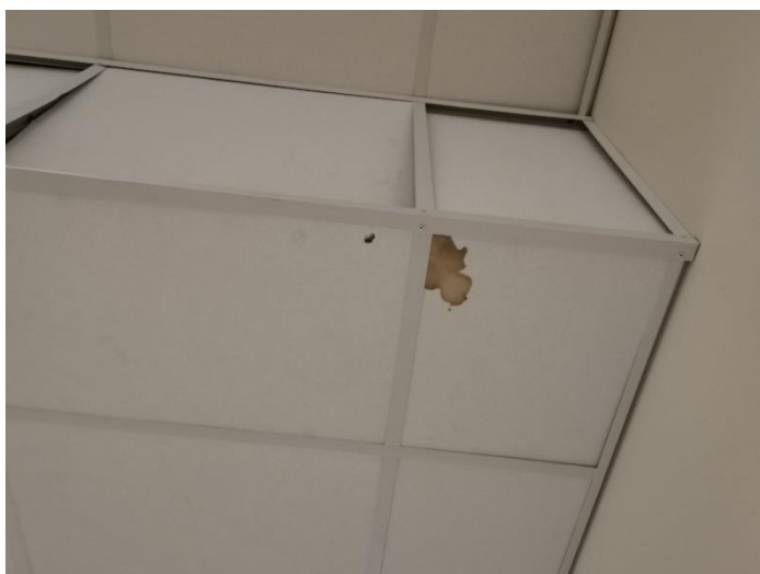
Figur 423 Fuktskade i himling i gang, plan 1
