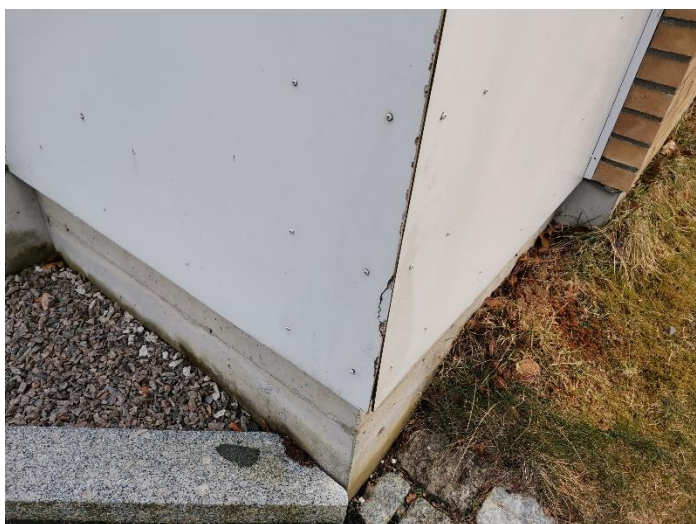
Figur 417 Sprekker i fasadeplate
