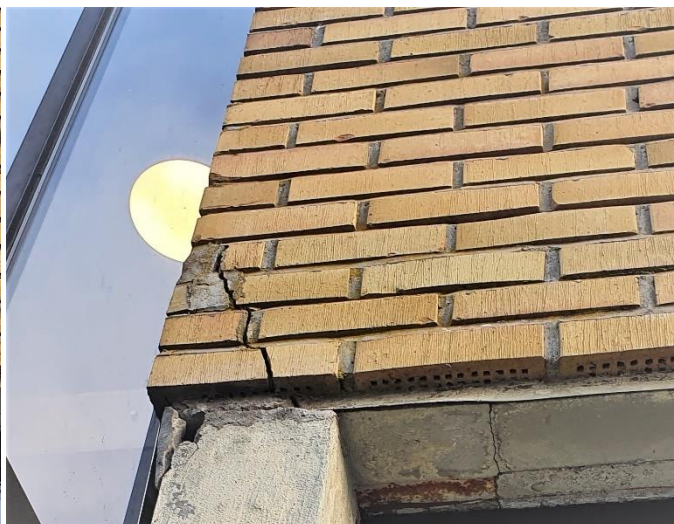
Figur 126 Sprekker på yttervegg, plan 1
