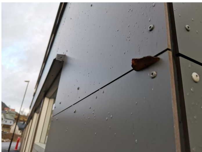
Figur 415 Soppvekst på fasadeplate. Sannsynlegvis vedmusling
