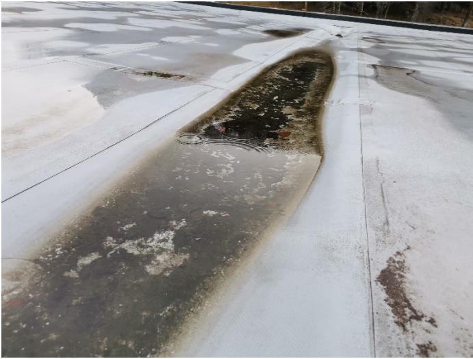
Figur 607 Dam på tak
