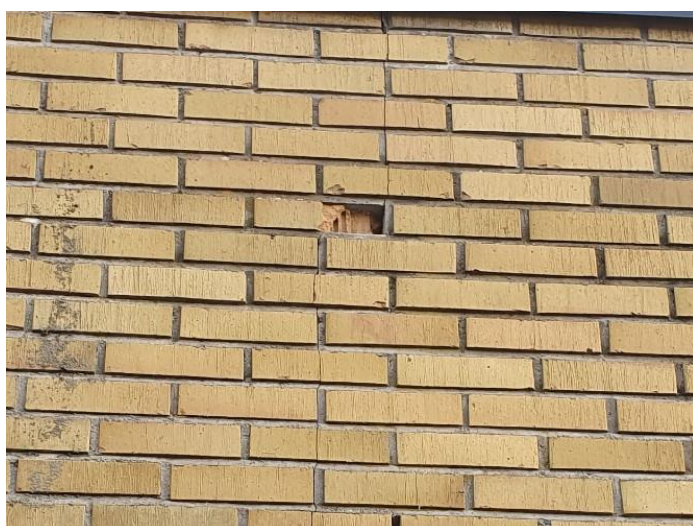
Figur 124 Langsgående sprekk og hol i vegg på yttervegg, plan 1
