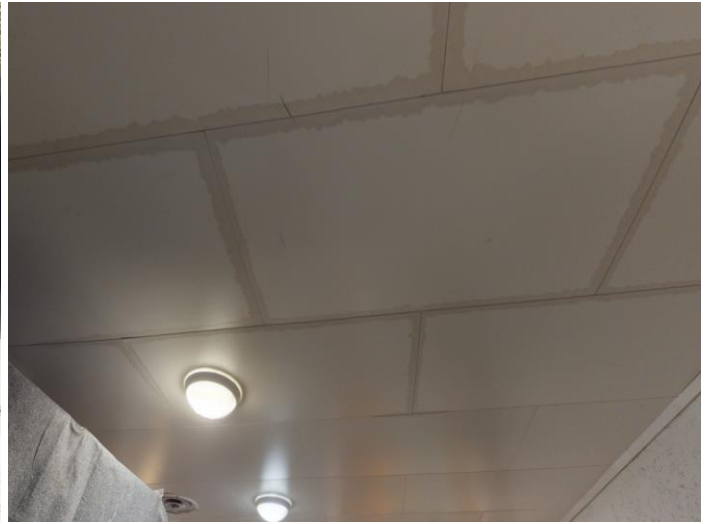
Figur 408 Fukt i himling i lager ved sidan av bassengkjeller, plan 0
