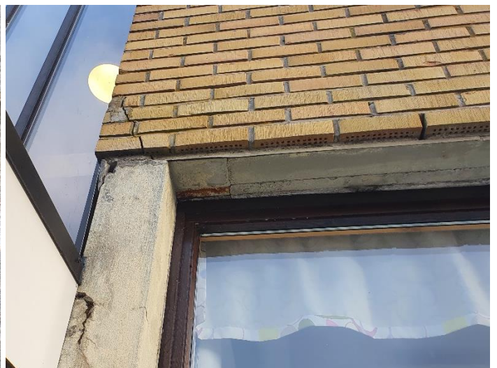
Figur 106 Betong bærebjelke korrosjon & synleg armering, plan 0
