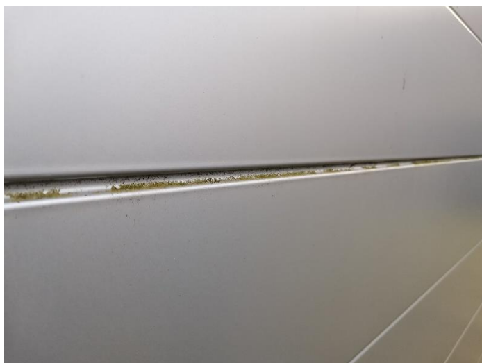
416 Mosevekst på fasaden
