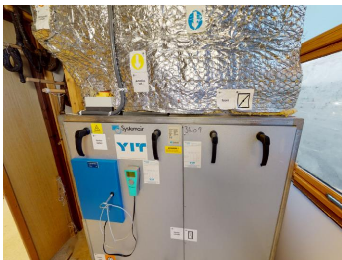
Figur 136 Ventilasjonsaggregat ved skulekjøkken
