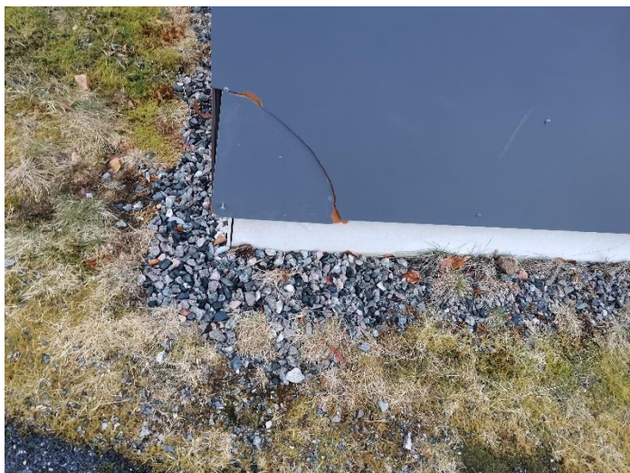
Figur 413 Laus kant på fasadeplate
