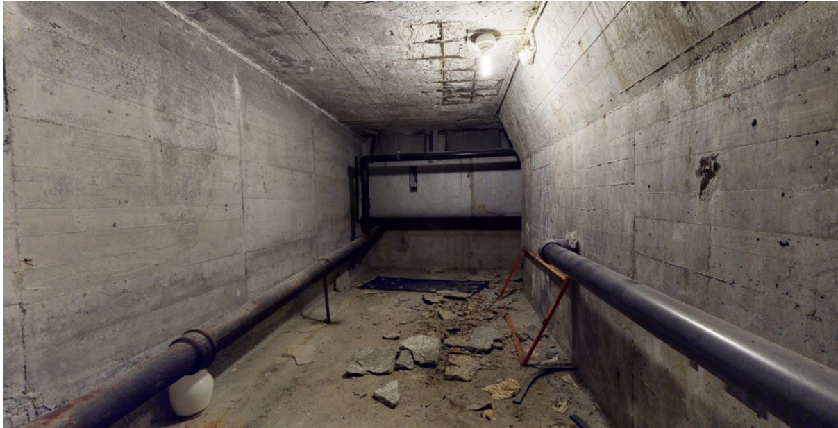
Figur 6 - 3: Synleg armering som har "sprengt" vekk overdekning
