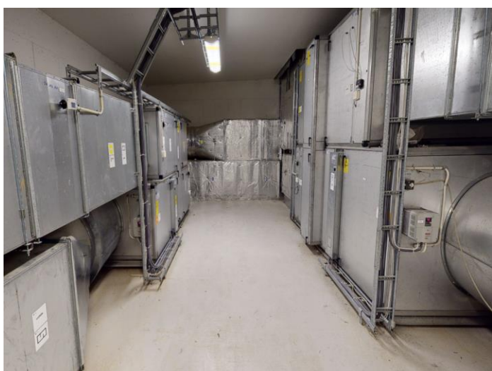
Figur 135 Ventilasjonsaggregat i teknisk rom, plassert i fløy A plan 0
