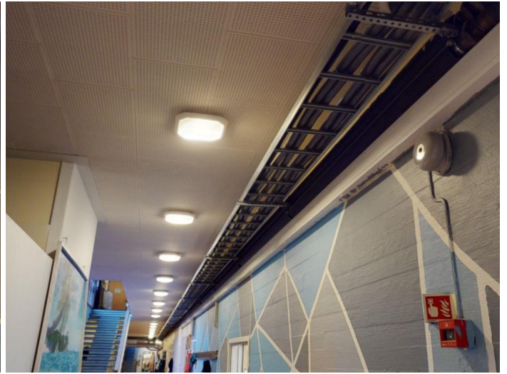
Figur 138 Synleg kabelføring frå sikringskap ved bassengkjeller
