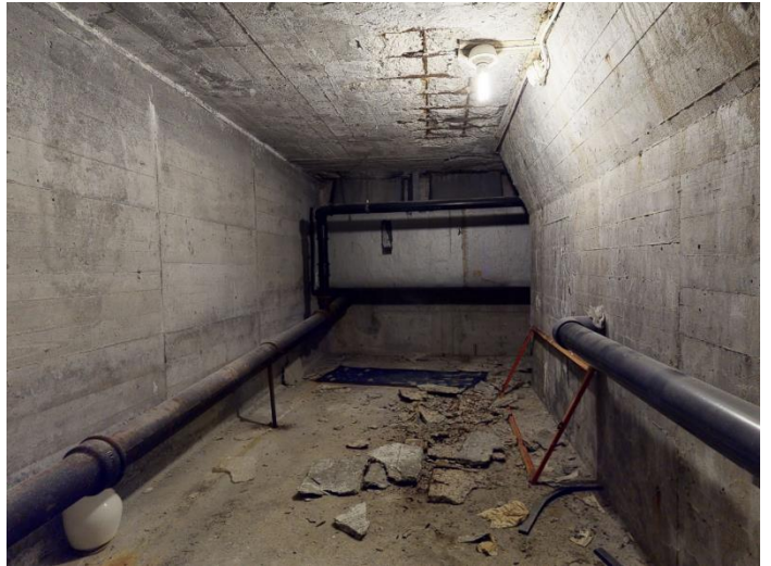
Figur 426 Synleg armering og sprengt betong under basseng, plan 0
