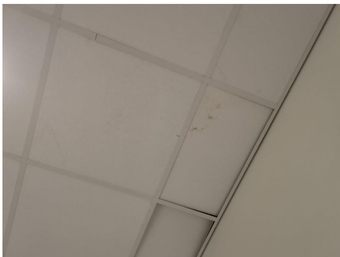
Figur 421 Fuktskade i himling i gang, plan 1
