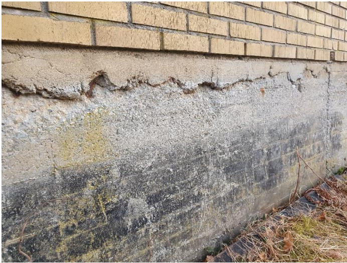
Figur 101 Betongvegg dårleg flikking, plan 0
