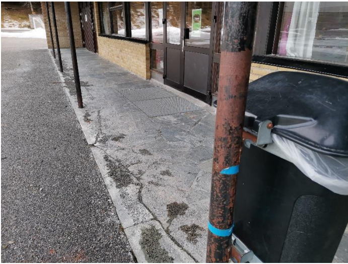
Figur 201 Korrosjon på stål søyle
