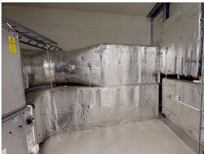
Figur 133 Isolert ventilasjonsrør, plan 0
