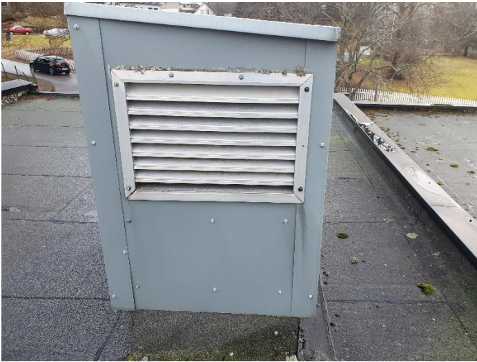
Figur 609 Andre ventilasjonsaggregat på tak
