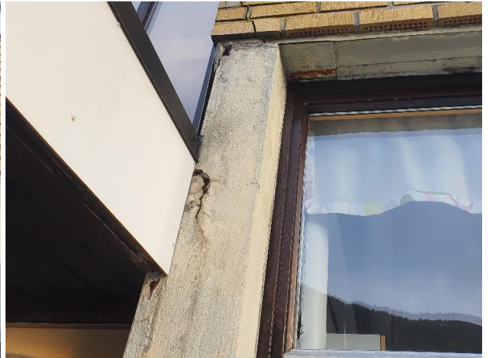
Figur 108 Berande betongsøyle setningskade, plan 0
