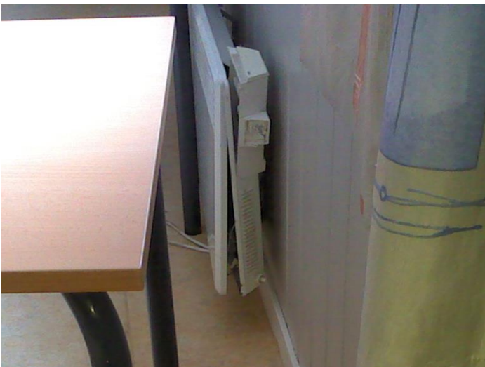
Figur 311 Skade på panelomn
