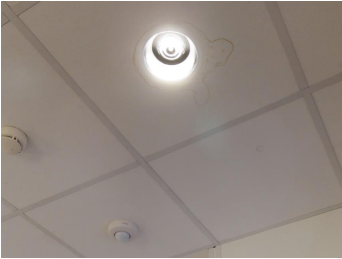
Figur 313 Fuktskadar rundt lysarmatur
