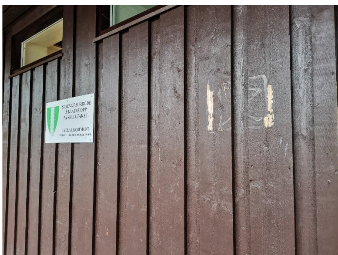
Figur 209 Fjernet markering av brannslange
