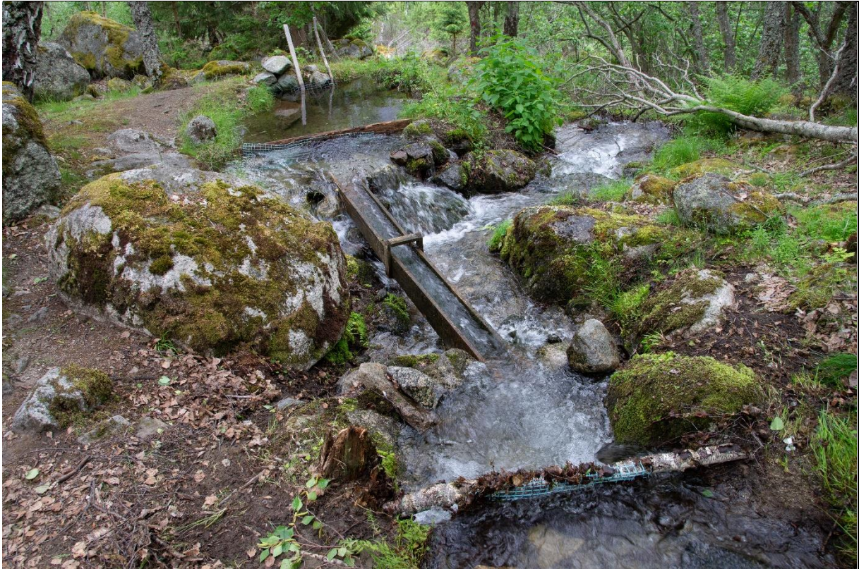
Figur 25. Inntaksdam til trykkvatnsanlegg på Rikheim med sil («tråsågard»), treslók og inntaksdam til røyrgate.
