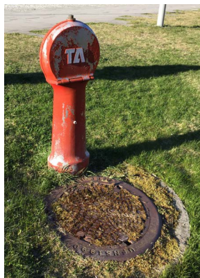
Figur 65: Brannhydrant og kumlokk.
