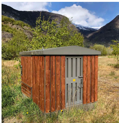
Figur 64: Trafostasjon sentralt i området.
