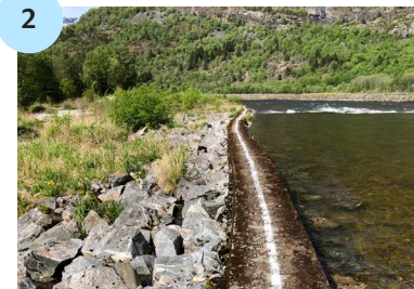
Figur 78: Ekstra sikringstiltak er gjort langs Lærdalselven i form av sementmurer.
