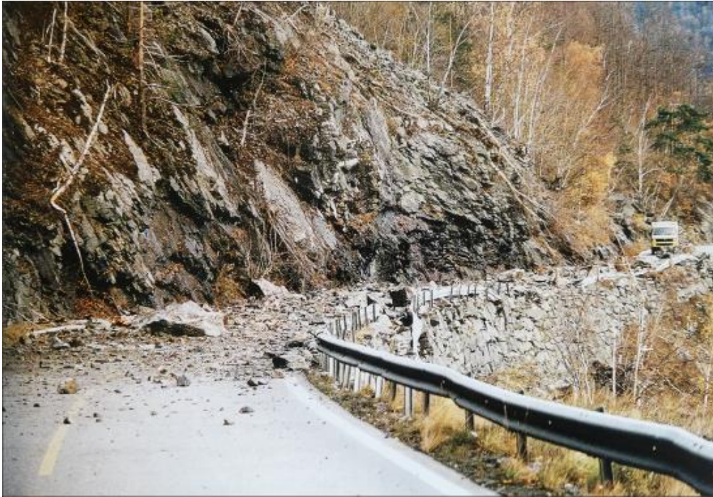
Figur 15: Steinsprang i 1997, om lag 500 m aust for skredoverbygget ved Rubbeskallen (Ese, 2007).
