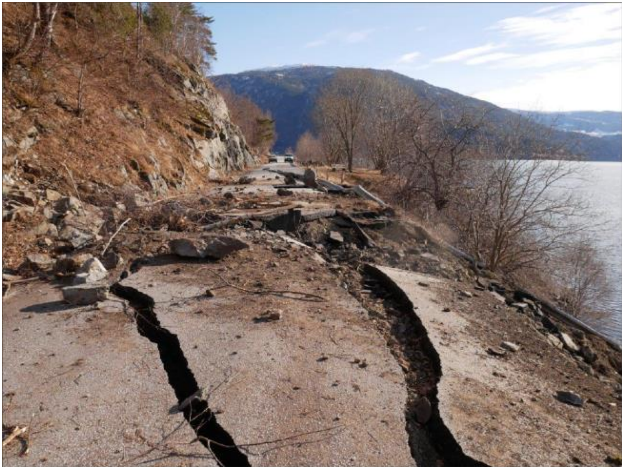
Figur 17: Skaden på vegen etter steinspranget 31.03.2018. Foto henta frå Statens vegvesen (2018b).
