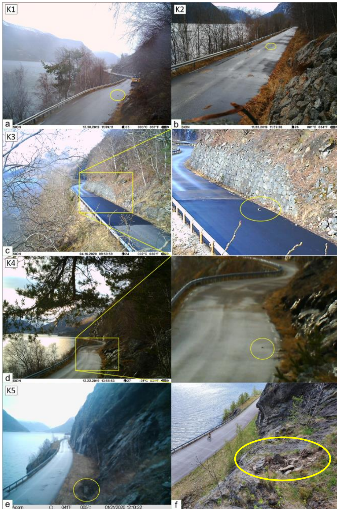
Figur 41: Eit utval av observasjonar gjort med viltkamera, a) K1, b) K2, c) K3, d) K4, e) K5 og f) losneområde for steinspranget i e), om lag 20 m over vegbana.
