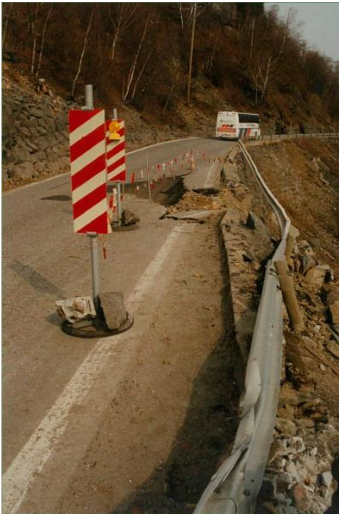
Figur 16: Skaden på vegen etter steinsprang i 1994. Foto henta frå Statens vegvesen (1994).
