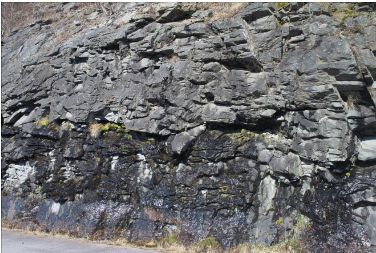
Figur 6: Oppsprukken vegskjering med tydeleg vatn i sprekkene. Foto teke 06.04.2020.
