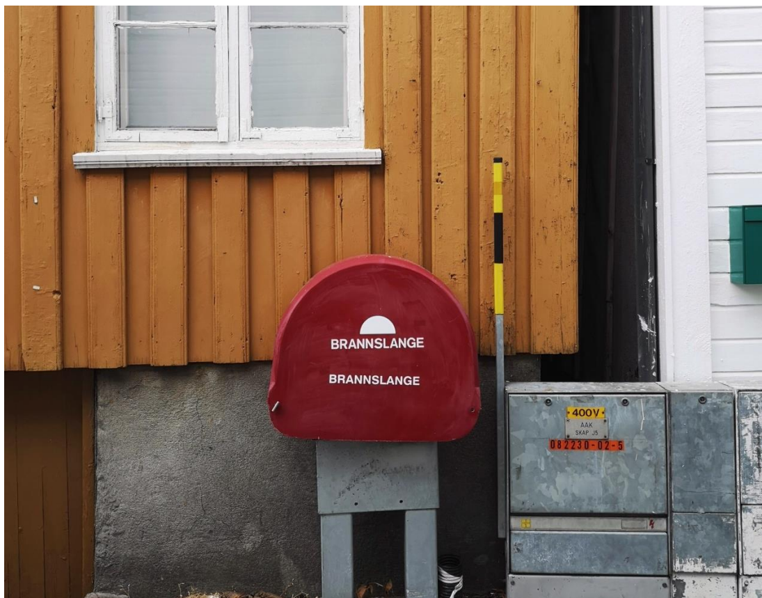
Figur 52: Eksempel på slokkepost plassert i trehusmiljø. Foto: Martin Kristoffersen.
