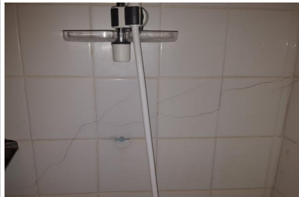
Bilde nr. 1.62 Utbredt riss flisoverflate i dusjanlegg.
