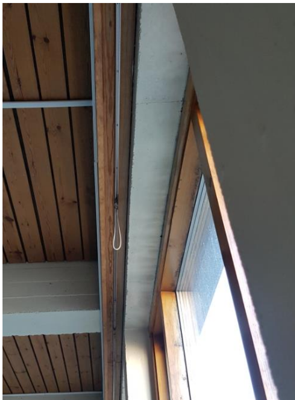
Bilde nr. 1.43 Støvkondens over vindu
