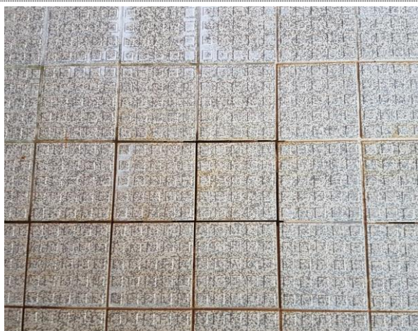
Bilde nr. 1.29 Eksempel på større parti med bom i fliser på promenadedekke. Partiet har også fuger som er helt tæret bort.
