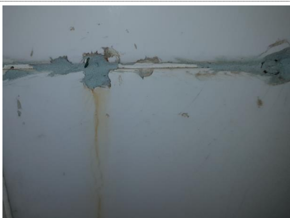
Bilde nr. 1.63 Utbedring av utette flisfuger med fugemasse. Rustavsetning på flisoveflate
