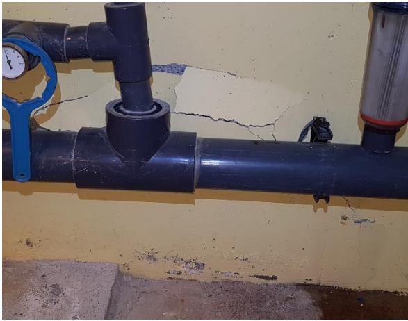
Bilde nr. 1.87 Større avskaling betongvegg og fuktighet på betonggulv
