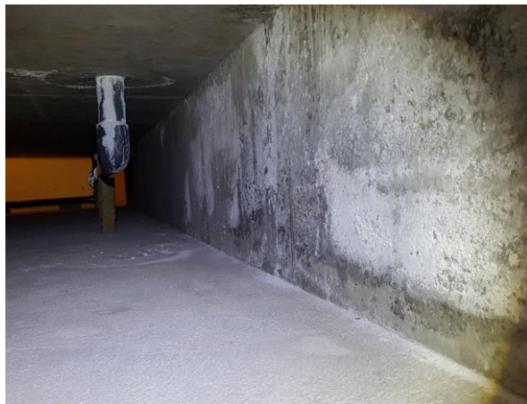
Bilde nr. 1.71 Kalkutfelling på vegg underkant av bassengtrau
