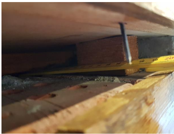
Bilde nr. 1.49 Åpen spalte ved utforing under vindu.
