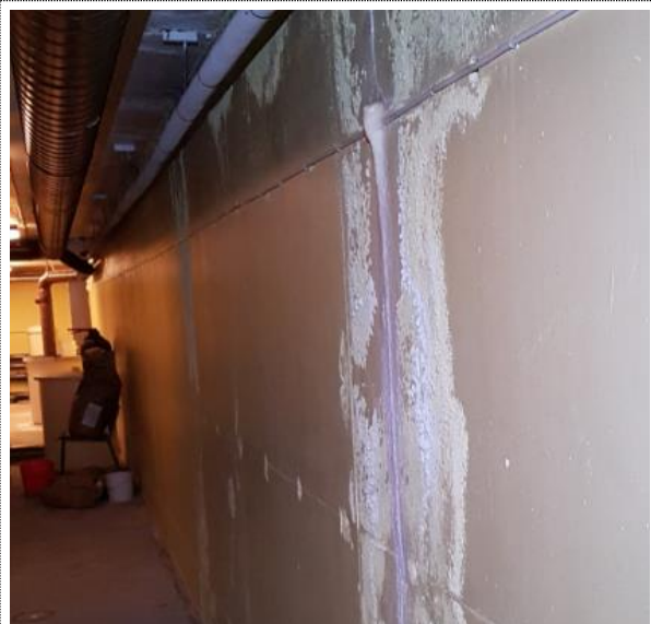
Bilde nr. 1.76 Kalkavsetninger og riss i yttervegg mot det fri.
