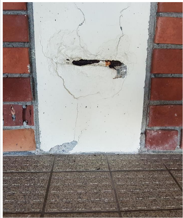
Bilde nr. 1.42 Armeringskorrosjon, riss og avskaling av betong i bærende betongsøyle i yttervegg mot terreng.
