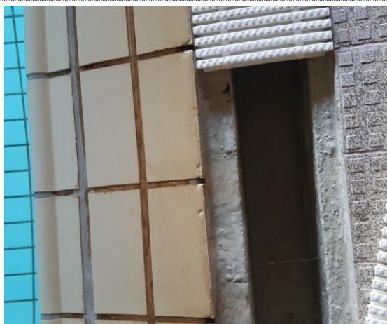
Bilde nr. 1.27 Misfarging av fuger
