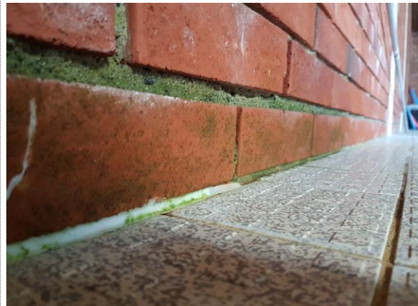
Bilde nr. 1.36 Algevekst på nedre del av tegl og fuger i overgang mot promenadedekke.
