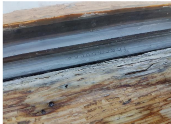
Bilde nr. 1.48 To lags luftfylt vindu uten energisparebelegg, med Thermopan avstandslist. Økende tegn på fuktbelastning inn mot glass.
