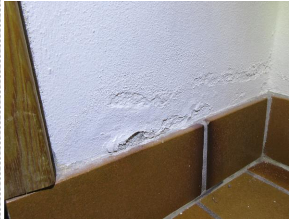
Bilde nr. 1.60 Blemmer og malingsavflassing i malingsfilm ved WC
