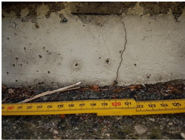
Bilde nr. 1.05 Et av flere vertikale riss på nordøstfasade
