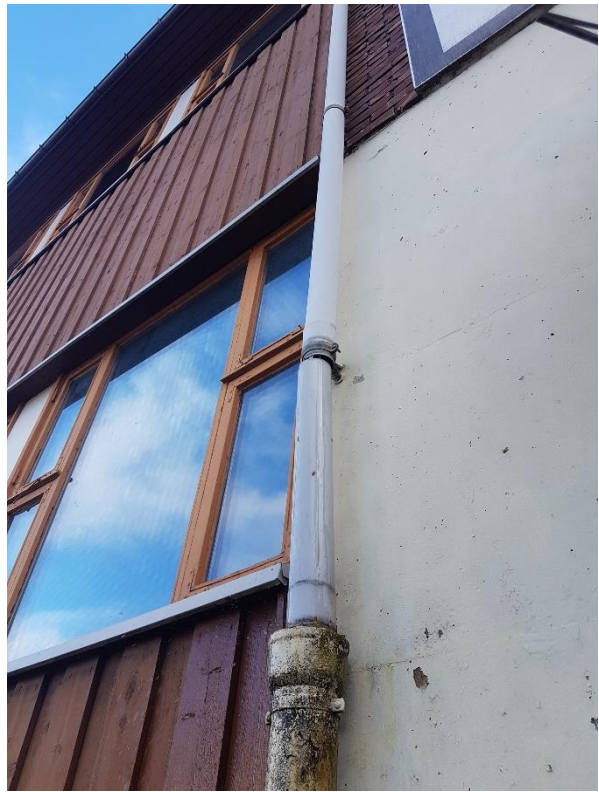
Bilde nr. 1.04 Utett nedløp som fører til fuktbelastning på yttervegg
