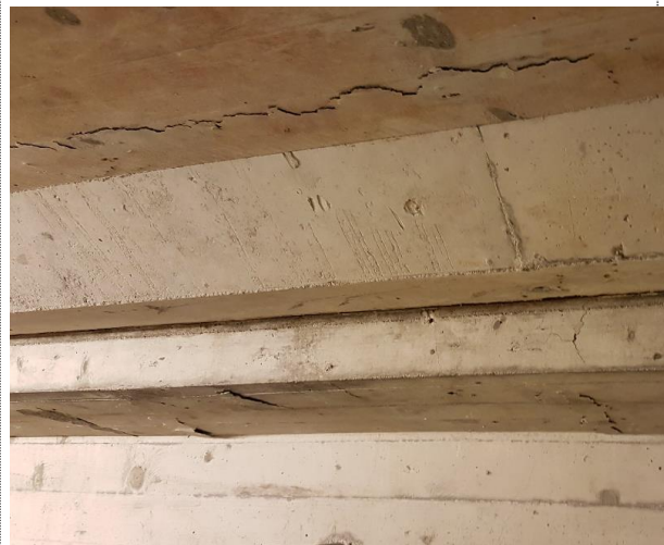
Bilde nr. 1.68 Korrodert armering og avskaling i del av konsoll/underkant av renne i del over utjevningsbasseng. Synlig korrodert bølgearmoring i del direkte utenfor basseng.
