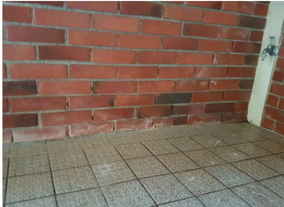
Bilde nr. 1.37 Synlig økt fuktbelastning i del mot tappekran på yttervegg. Det registreres mørkere tegl inn mot hjørne som følge av fukt, tæring av murfuger, kalkavsetning og algevekst i denne delen.
