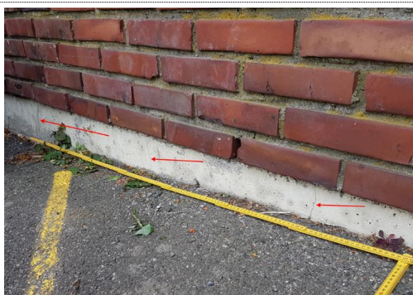
Bilde nr. 1.11 Riss på nordøstfasade merket av med piler på bilde
