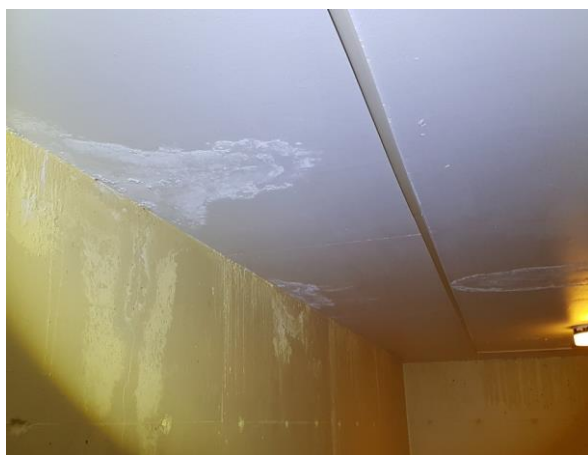
Bilde nr. 1.75 Kalkavsetninger på dekke og yttervegg
