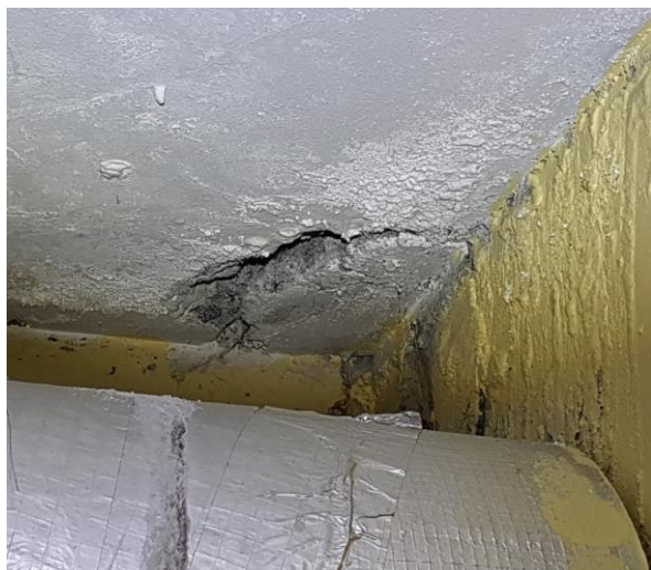
Bilde nr. 1.79 Avskaling på dekke inn mot yttervegg
