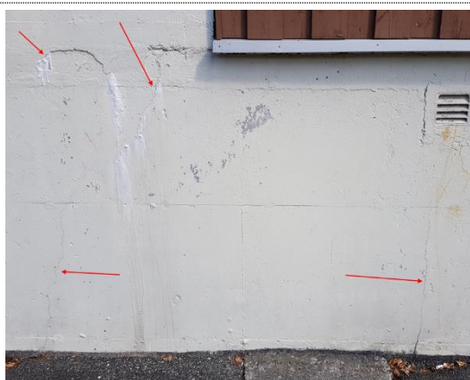
Bilde nr. 1.12 Riss på sørvestfasade merket av med piler på bilde. Riss har også kalkutfellinginger.
