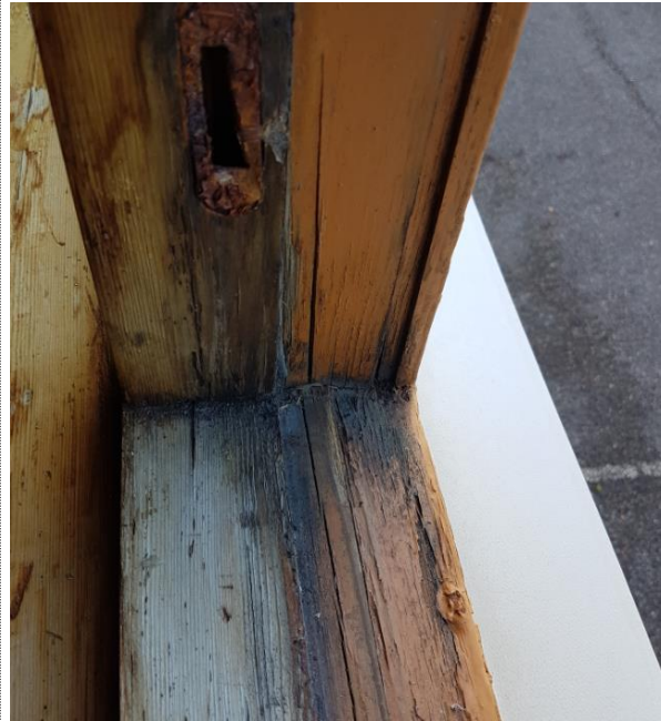
Bilde nr. 1.46 Fuktskade på vindu. Råtekader på karm og korrosjon på haspe og låsepunkt. Mangelfull tettelist mellom karm og ramme
