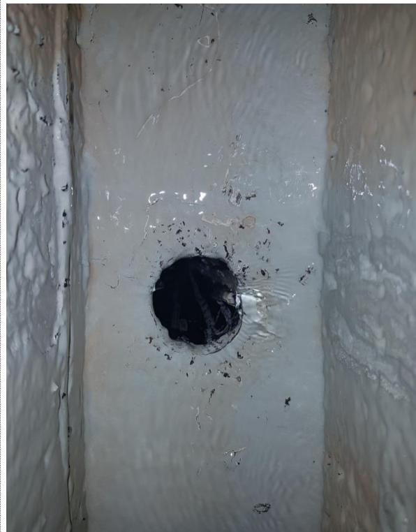
Bilde nr. 1.24 Sluk. Synlig utbulende fuge til venstre.
