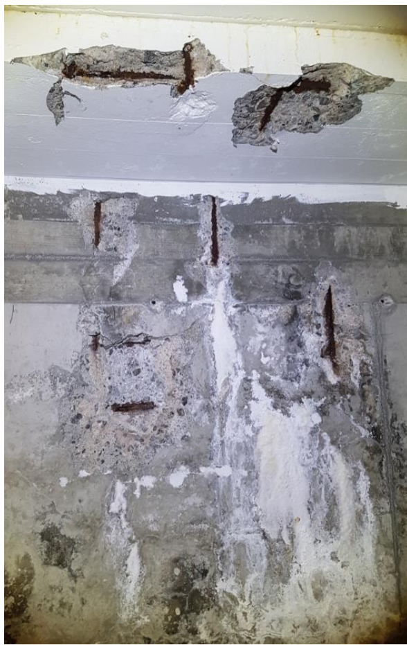
Bilde nr. 1.73 Omfattende avskaling, korrosjon og kalkutfelling på bassengvegg og renne. Tegn til lekkasjer i form av rennemerker fra fuge.
