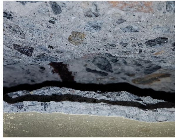
Bilde nr. 1.88 Nærbilde av avskaling viser korrodert armeringsjern
