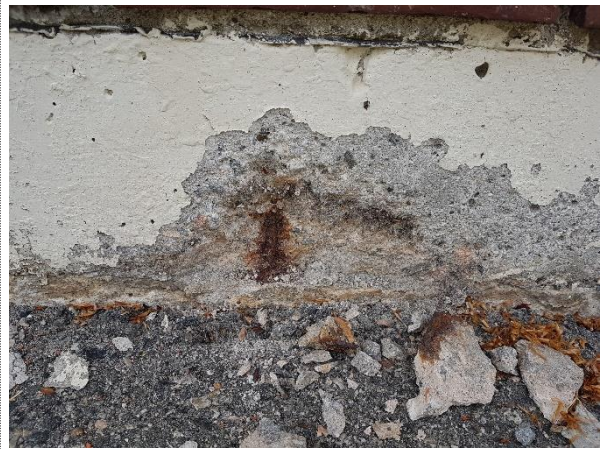
Bilde nr. 1.06 Riss og avskaling som følge av korrodert armering
