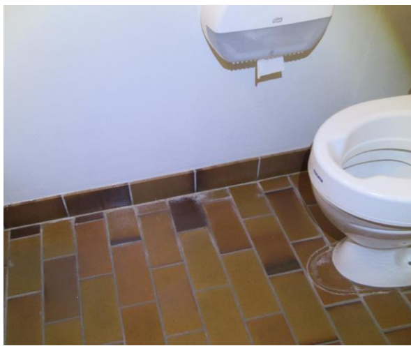
Bilde nr. 1.59 Kalkufelling i gulvflis ved WC i vegg inn mot svømmehall
