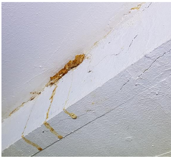
Bilde nr. 1.81 Hengende dråper som følge av lekkasje fra fuge.
