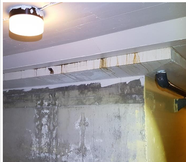
Bilde nr. 1.80 Rennemerker av forurenset vann fra fuge. Kalkutfelling på vegg
