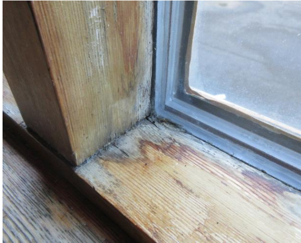
Bilde nr. 1.45 Fuktskade på vindu. Grånende og oppsprekt trevirke
