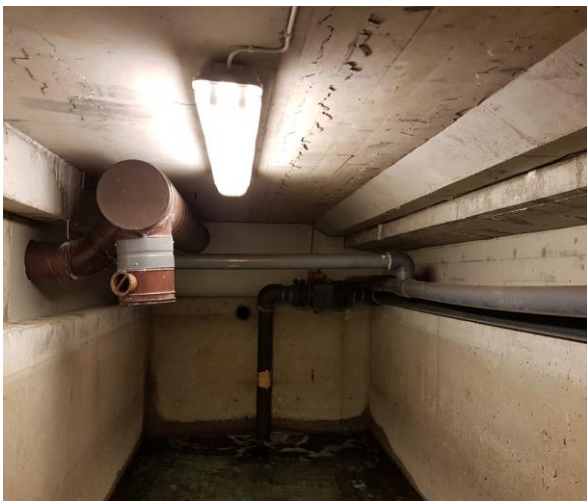
Bilde nr. 1.67 Korrodert armering og avskaling i dekke over utjevningsbasseng
