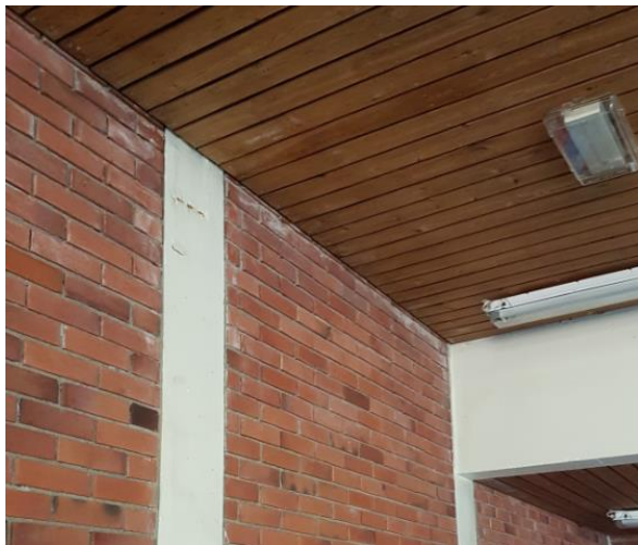
Bilde nr. 1.39 Armeringskorrosjon og begynnende avskaling på søyle i vegg mot nordvest. I overgang mot dekke sees saltavsetninger.
