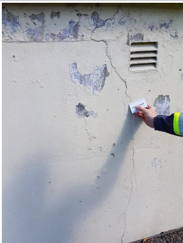
Bilde nr. 1.09 Langstrakt riss med stort bomparti på sørvestfasade. Malingsavflassing som følge av transport av salter bak malingsfilm
