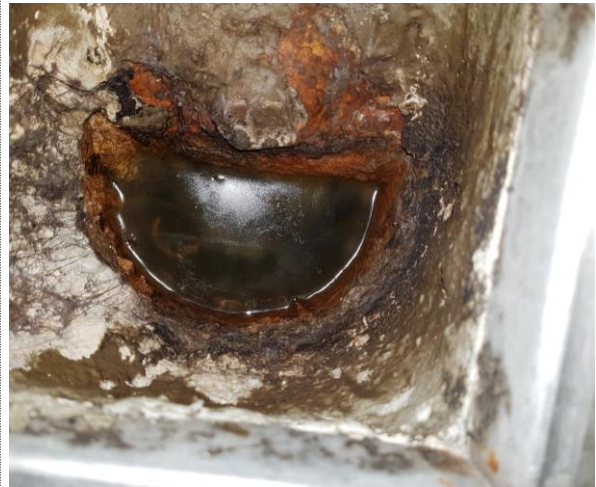
Bilde nr. 1.66 Avleiringer i renne. Korrosjon i sluk
