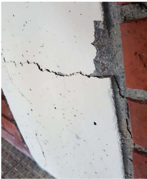
Bilde nr. 1.41 Større avskaling i nedre del av bærende betongsøyle i yttervegg mot terreng.
