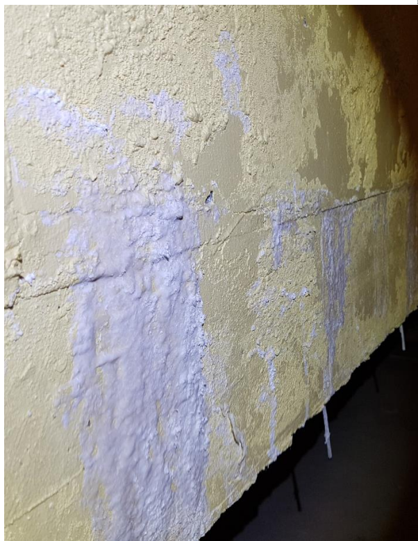
Bilde nr. 1.69 Lekkasje og større parti med kalkavsetning i støpeskjøt mellom bassengbunn og bassengvegg
