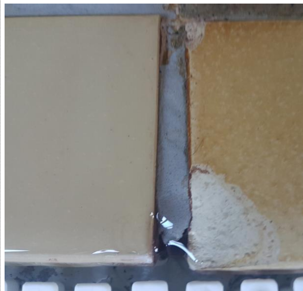
Bilde nr. 1.22 Eksempel på tæring av fuge i basseng, samt avskaling av keramisk flis.
