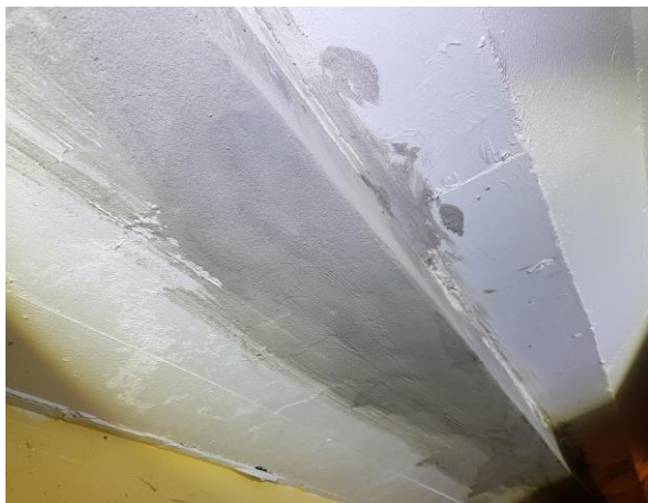
Bilde nr. 1.83 Tidligere utbedring med bom i underkant av renne
