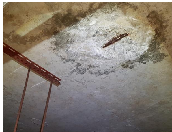
Bilde nr. 1.84 Korrodert armering i dekke. Muligens som følge av lekkasje fra gang eller dusjanlegg i etasjen over.
