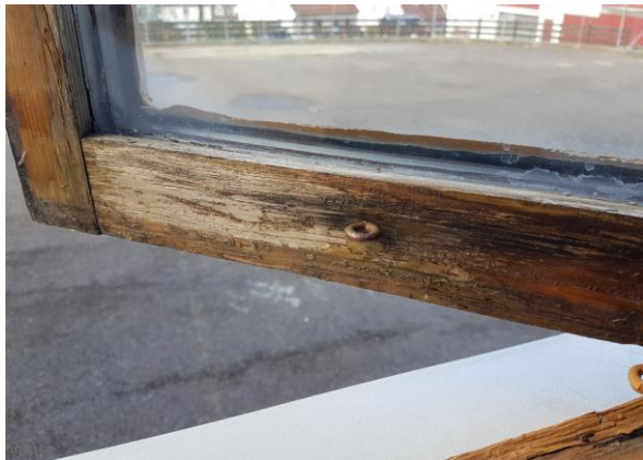
Bilde nr. 1.47 Råteskade i ramme
