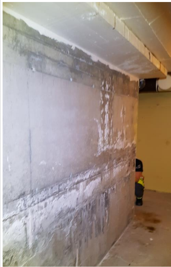
Bilde nr. 1.74 Kalkavsetninger på bassengvegg og rennemerker fra fuge
