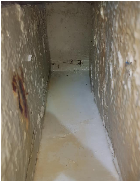
Bilde nr. 1.23 Armeringskorrosjon/rustmerke i renne
