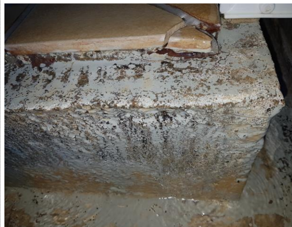
Bilde nr. 1.26 Brudd i flis på hjørne av renne i sørøstredel. Betraktelig synlig forskjell i tetthet på overflatebehandling ved sammenligning mot motstående del.
