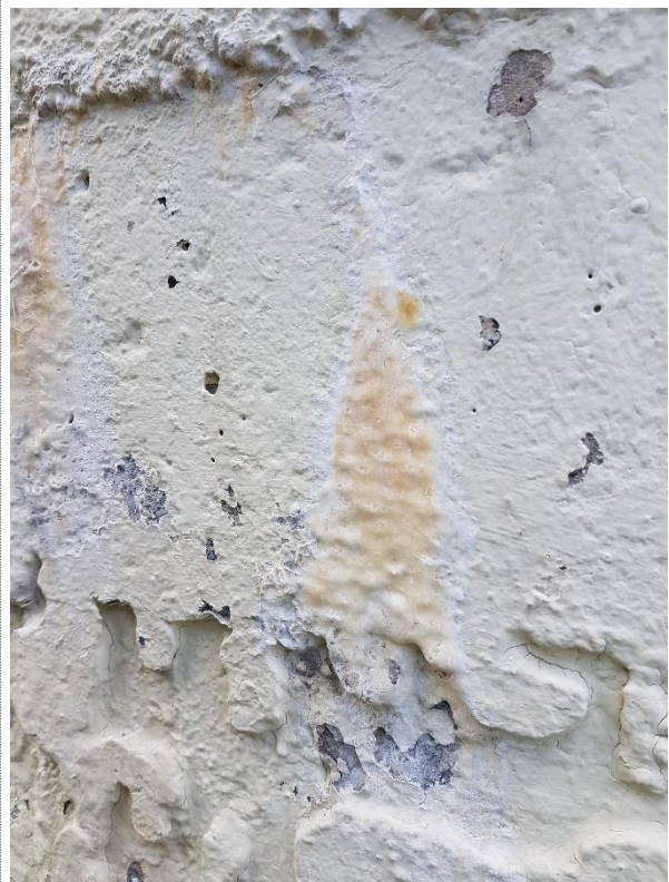
Bilde nr. 1.08 Kalkutfellinger på nordvestfasade
