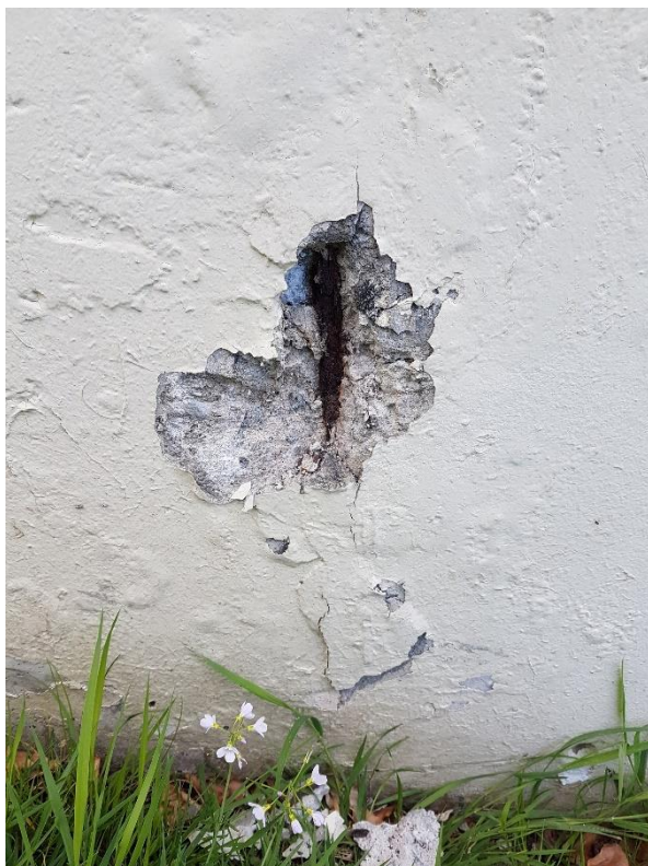
Bilde nr. 1.07 Eksempel på avskaling og korrodert armering på nordvestfasade
