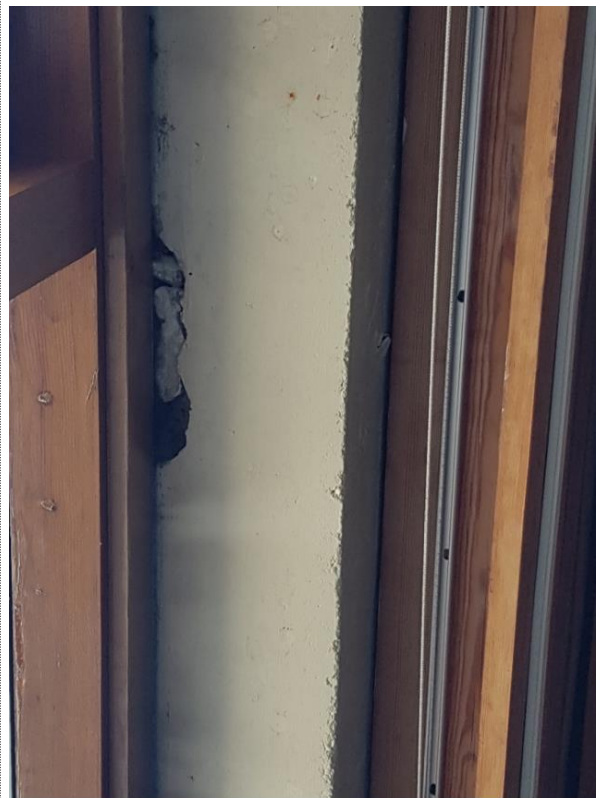
Bilde nr. 1.44 Avskaling i betongdrager over vindu.
