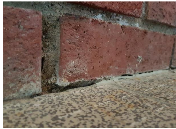
Bilde nr. 1.34 Synlig spalte mellom tegl og promenadedekke hvor vann kan renne fritt ned i underliggende konstruksjon.
