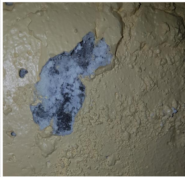
Bilde nr. 1.78 Nærbilde av saltavsetning og blemme i malingsfilm på bassengtrau
