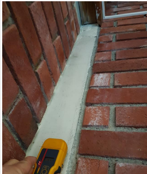
Bilde nr. 1.38 Kontroll med fuktindikator. Høyt utslag på fuktindikator, ca 2 m opp på vegg, viser at søyle i hjørne er særlig fuktbelastet.
