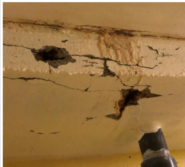
Bilde nr. 1.82 Riss og oppsprekking i renne inn mot rørgjennomføring. Kalkutfelling fra fuge.
