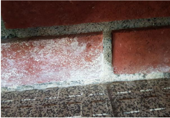
Bilde nr. 1.33 Synlig fuktopptrekk i form av kalkavstening på ubeskyttet tegl ned mot promenadedekke
