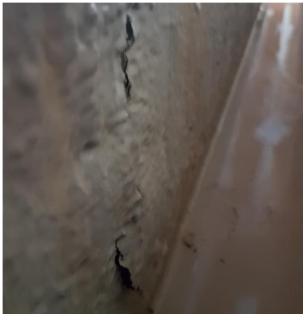
Bilde nr. 1.25 Oppsprekking av epoxybelegg i renne mot nordøst.
