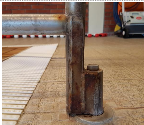
Bilde nr. 1.32 Nærbilde overflatekorrosjon på stål på leider
