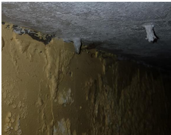
Bilde nr. 1.85 Lekkasje og stalaktitt i underkant av dekke inn mot yttervegg
