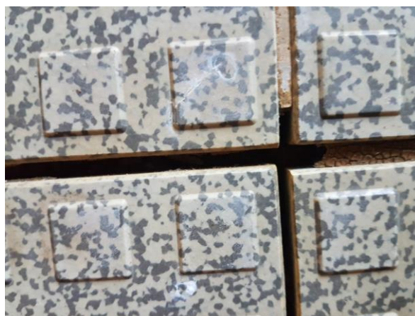
Bilde nr. 1.30 Nærbilde av fuger som er tæret bort på promenadedekke.
