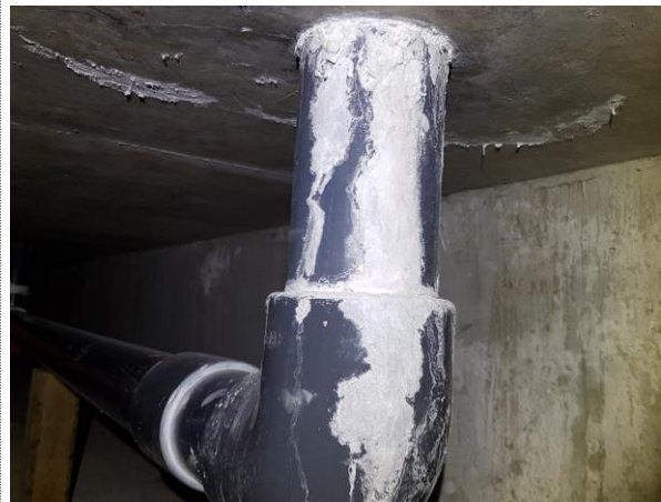
Bilde nr. 1.72 Kalkutfelling rundt rørgjennomføring
