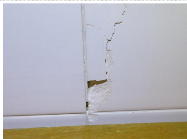
Bilde nr. 1.64 Flisbrekkasje i garderobe
