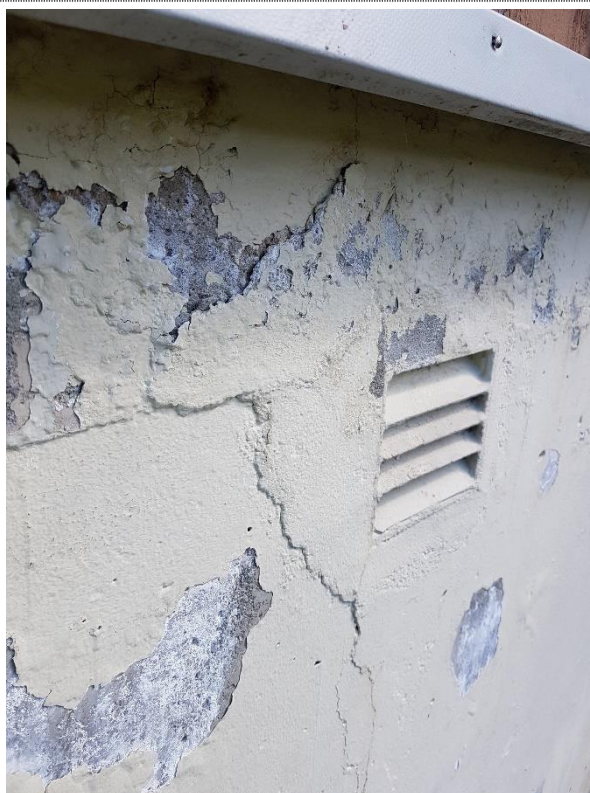
Bilde nr. 1.10 Nærbilde av bomparti og malingsavflassing
