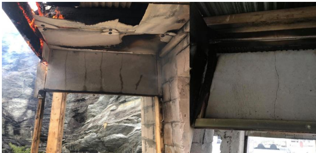
Bilde 8.3 – Eksponert og ueksponert side til Construction etter forsøk
