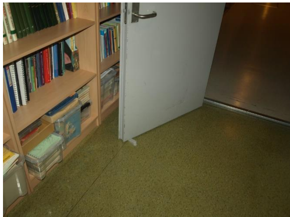
Bilde 8 Branndør mellom bygg A og B
