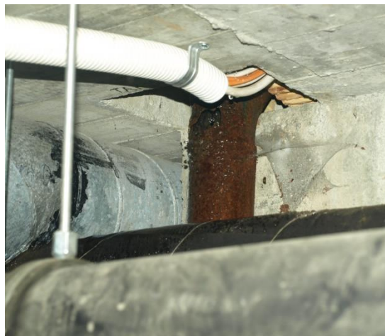
Bilde 3 Sprukke vassrøyr i bygg C
