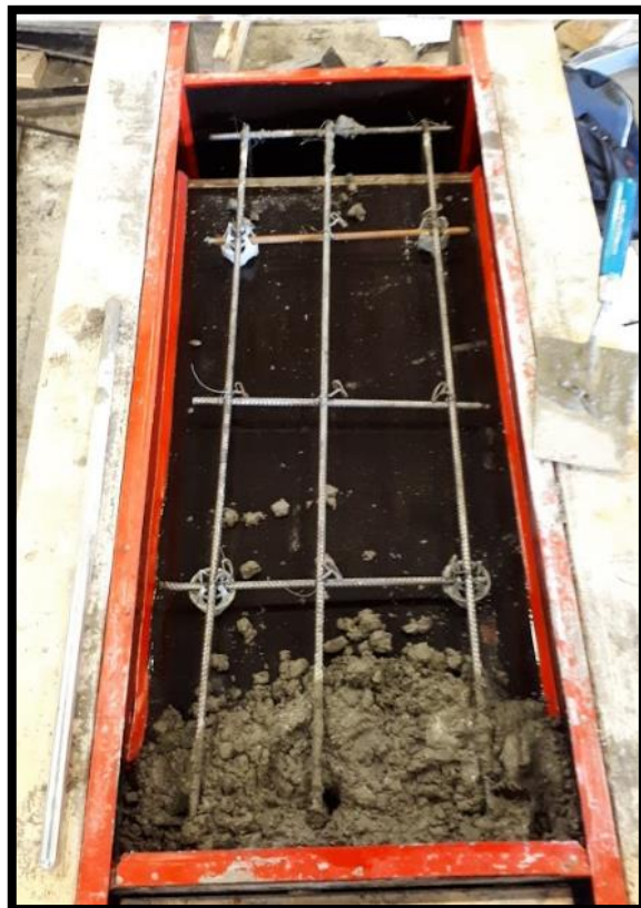
Figur 79: Viser Formene skrudd sammen og armering. På bunnen kan det ses at første delen av betongblandingen er tilført.
