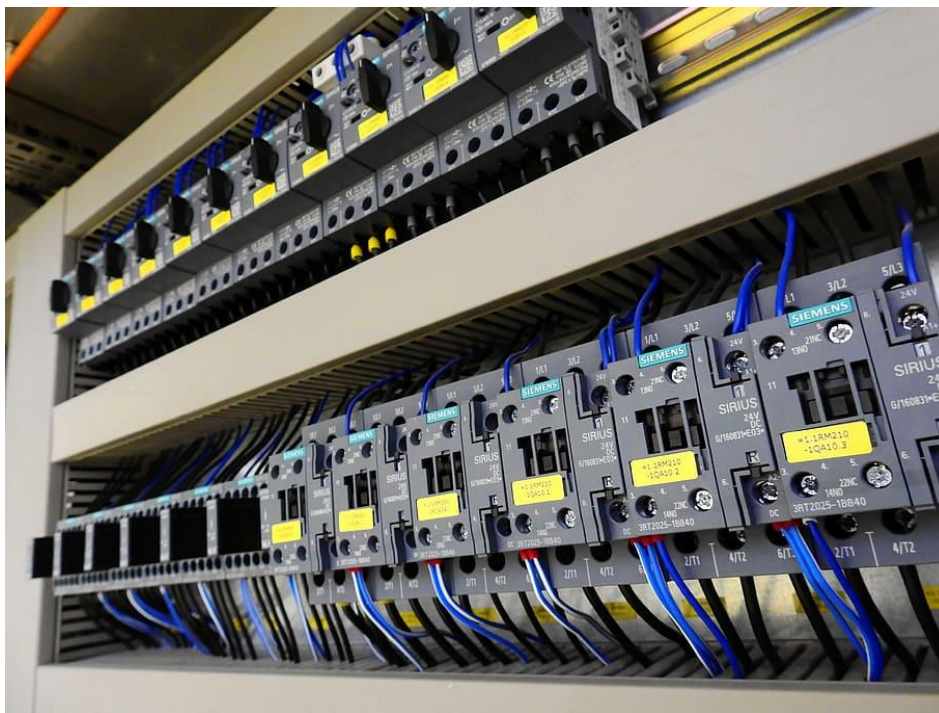
Figur 4: Bilde av styreskap med kontaktorer. Kilde: Wallpaperfare
