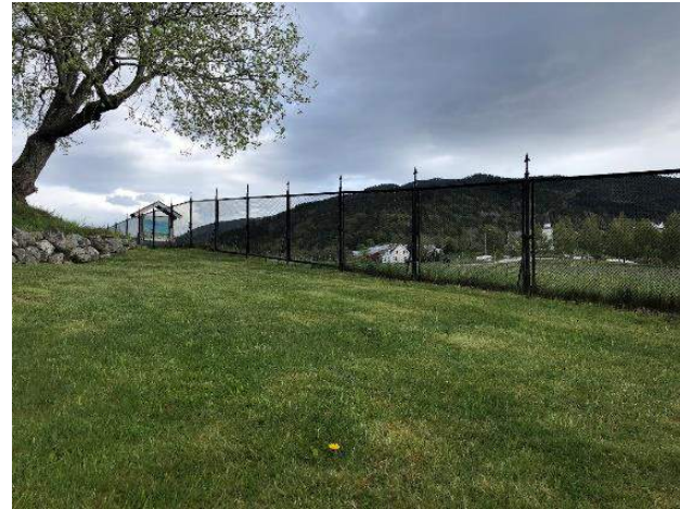
5. Gjerde - Et smijernsgjerde med dekorativt design omkranser parken. Smijernsgjerdet virker å være relativt vedlikeholdsfritt da det er lite preget av rust. Slike gjerder er typisk fra keiser Wilhelm sin tid. Designet har piler som minner om vikingtiden.
