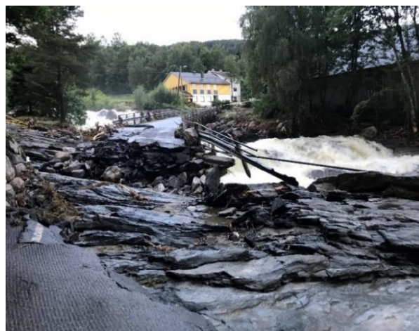
Figur 4: Flomskadet infrastruktur, Utvik (Statens vegvesen, 2017) Gjengitt med tillatelse
