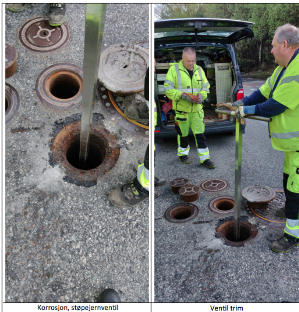
Figur 32: Kontrollering av ventiler og ventilstilling for kritiske ventiler. Foto: Kassem Ali Al-Sheikh
