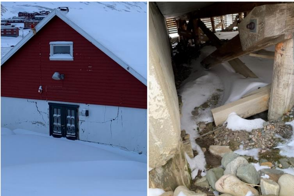
Figur 3-7: Betongskader på låven og råteskade i trepelene, foto: E. Vabø
