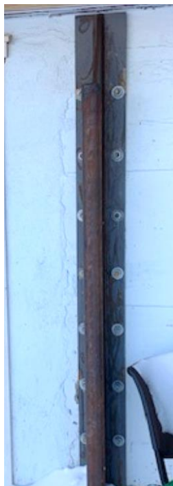
Figur 3-9: Ettermontert stålpel på Funken Lodge, foto: E. Vabø
