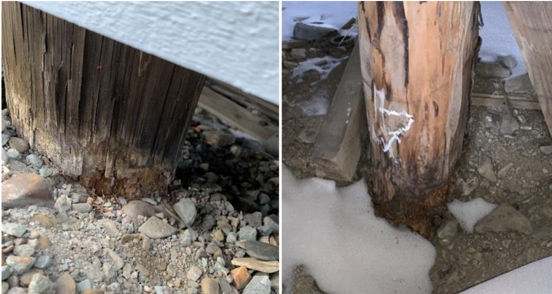
Figur 3-6: Råte trepeler under Svalbard kirke (t.v.) og Brakke 7 (t.h.), foto: E. Vabø
