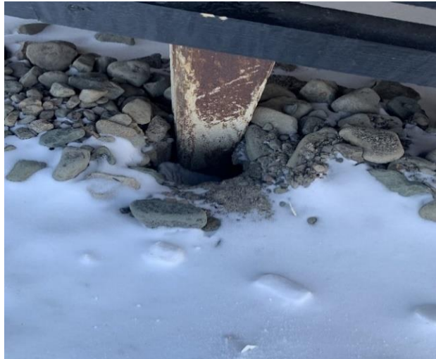
Figur 3-8: Rust på stålpel, foto: H. Kvalsund
