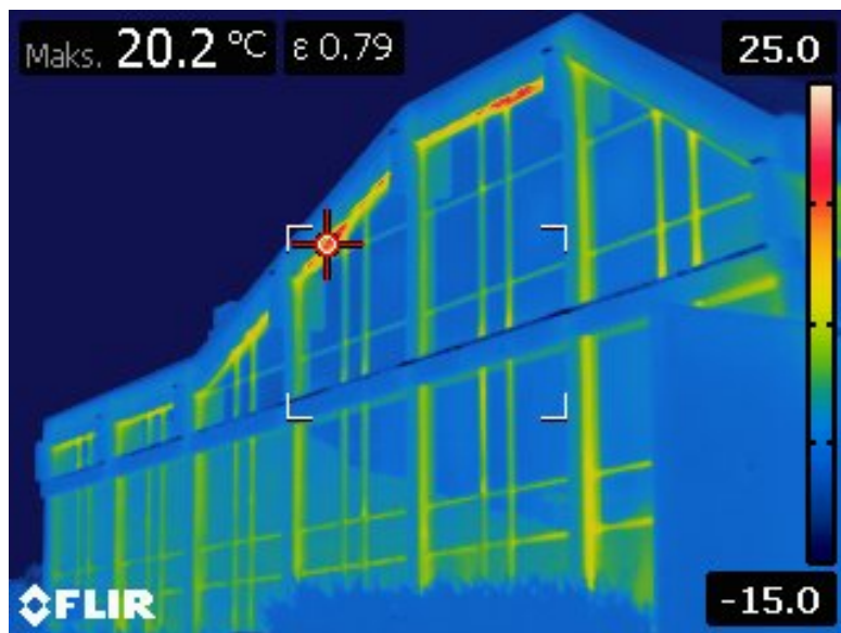
Figur 3.1: Bilete teke av sørfasaden til svømmehallen i Førdehuset som syner kuldebruer. Fotograf: Marta Hugøy Sandnes.
