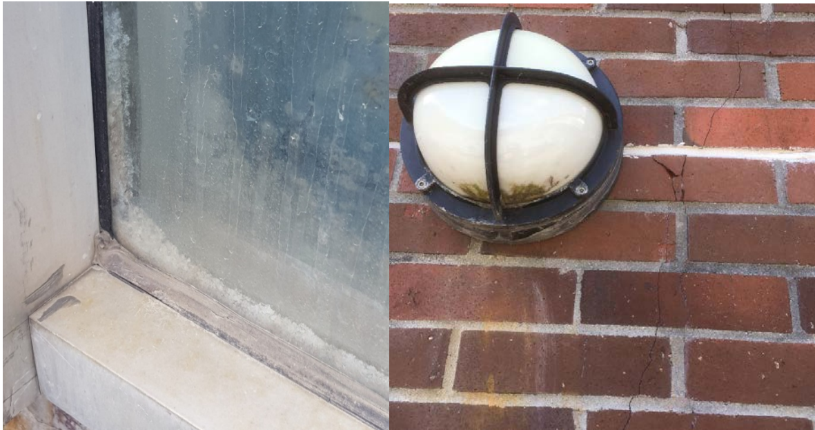
Figur 2.6: Bilete som syner saltkrystallar inne i eitt vindauge. Teglsteinsmuren i aust ber tydeleg preg av elde. Fotograf: Joakim Kvammen/ Viggo Leikanger.
