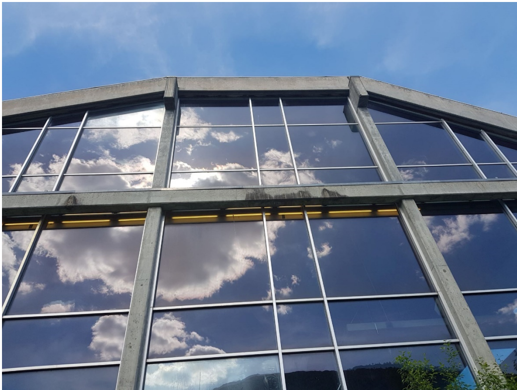
Figur 3.10: Bilete av sørfasaden i Førdehuset, bjelkar og søyler. Foto: Marta Hugøy Sandnes.
