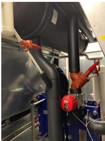
Figur 15: væskeutskiller i teknisk rom
