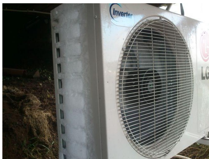
Figur 20: Varmepumpe med is på utedel [23]
