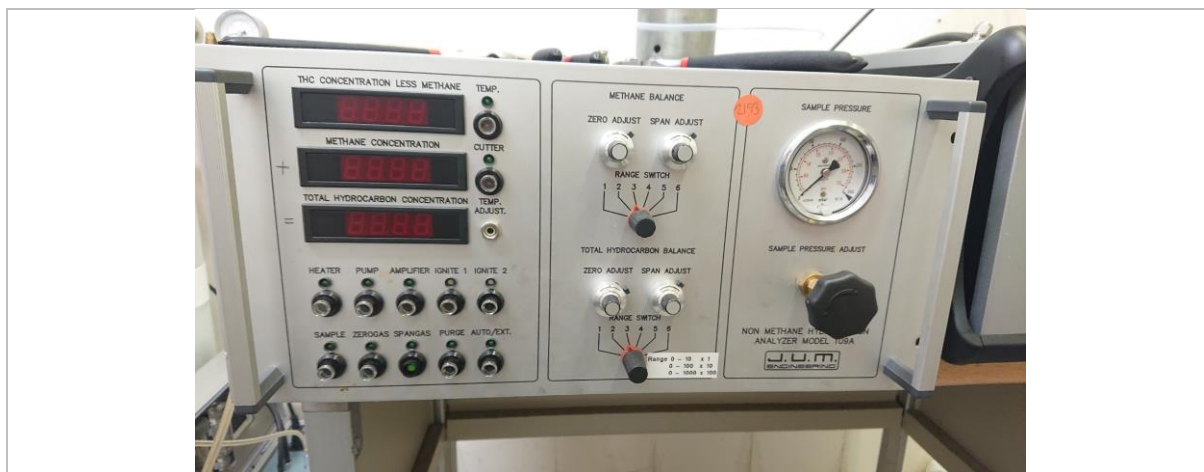
Figur 13: Bilde av FID i container
