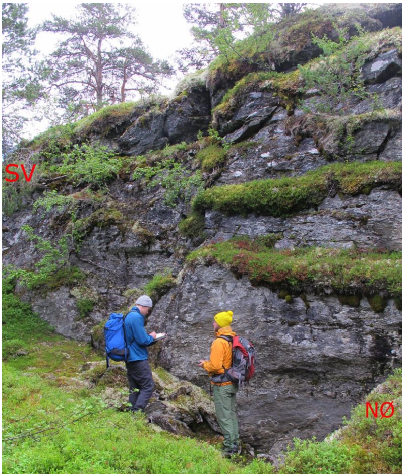
Figur 41 Observert skrent ca. 5 m høy og 60 m lang.
