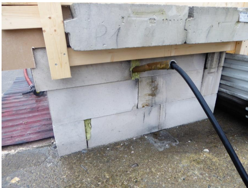
Bilde 4.4 Påfyllingsrør for etterfylling av brensel
