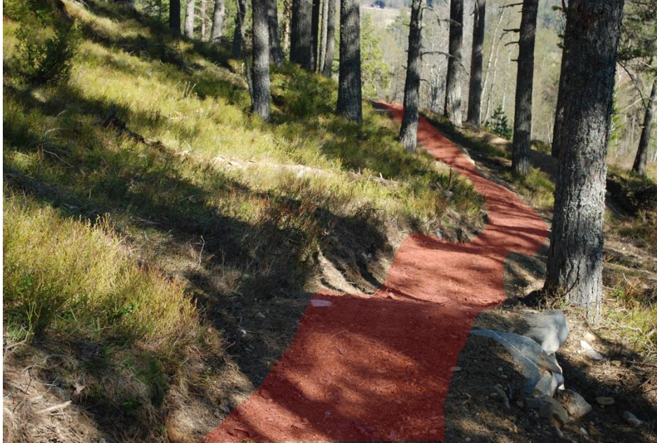
Figur 18: En sti med gradreversering, stien går i en rullende bølgeformasjon og kan skape variasjon og artig opplevelse å sykle på. Gradreversering gjør at vann ikke renner lengre strekker på stien.
