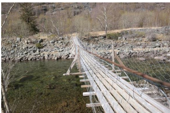
Figur 70: Sykkelveien går over en svært ustabil hengebro.
