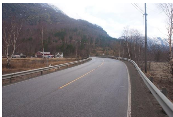
Figur 76: Sykling på E16 over broen kan by på farlige situasjoner. Veiskulderen er smal og fremstår ikke som trygg.
