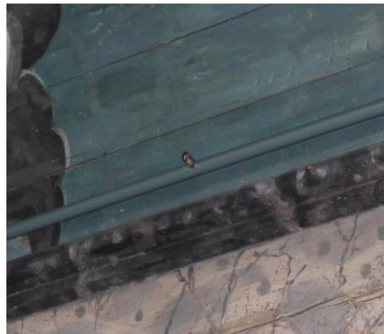
Bilde 5 - Eksempel på sprinkler installert på verneverdig bebyggelse (Foto: Kirkelig arbeidsgiver- og interesseorganisasjon)
