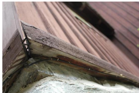
Bilde 4 - Eksempel på varmedetekterende linjer under kledningen (Foto: Kirkelig arbeidsgiver- og interesseorganisasjon)
