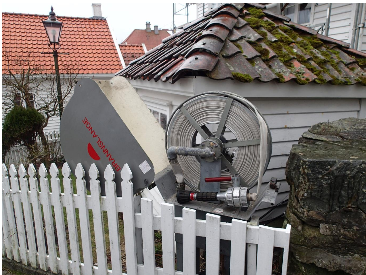
FIGUR 9 EN BRANNPOST I GAMLE SKUDENESHAVN
