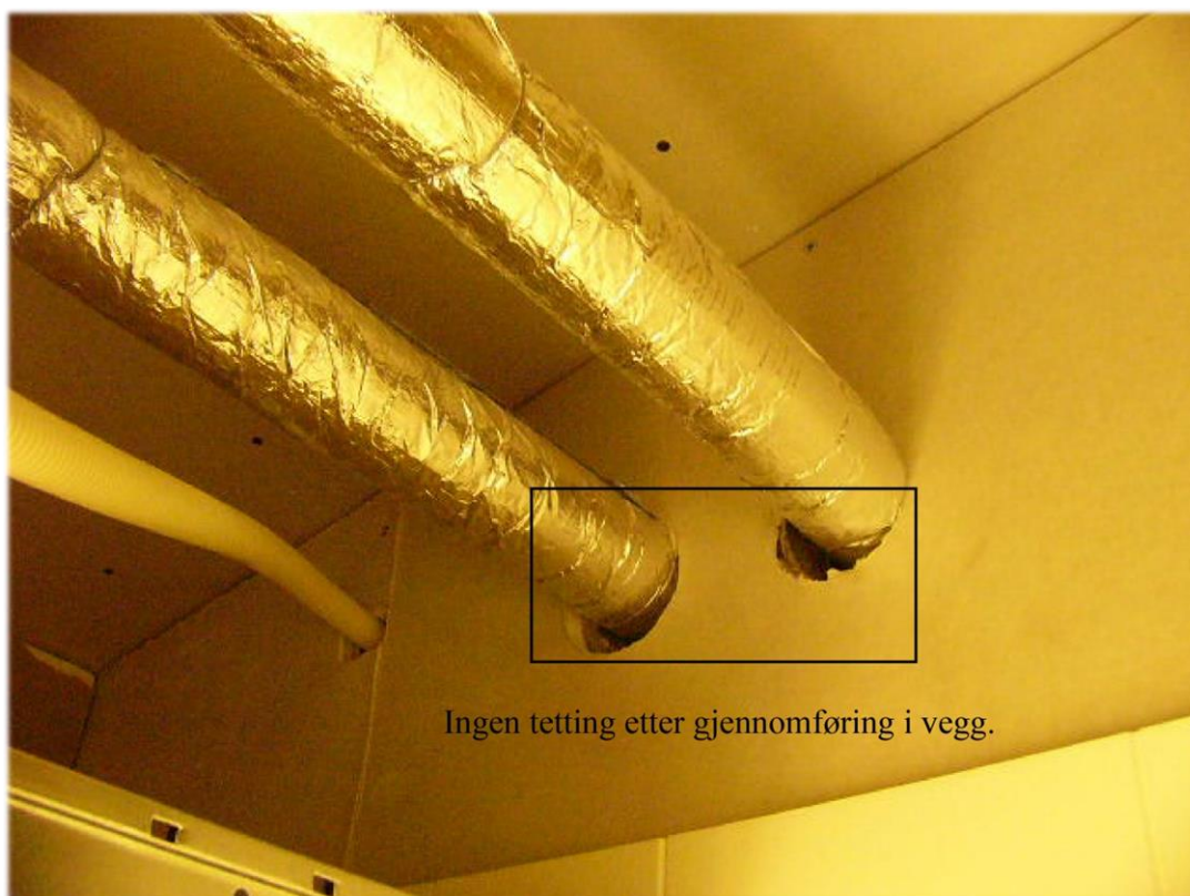
Figur 27 Ingen tetting etter gjennomføring, i tillegg til skeiv utsparing. (Olstad, 2013)
