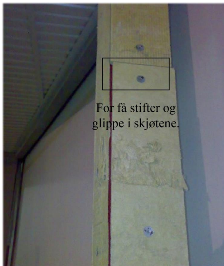
Figur 26 Feil utførelse av isolering (Olstad, 2013)
