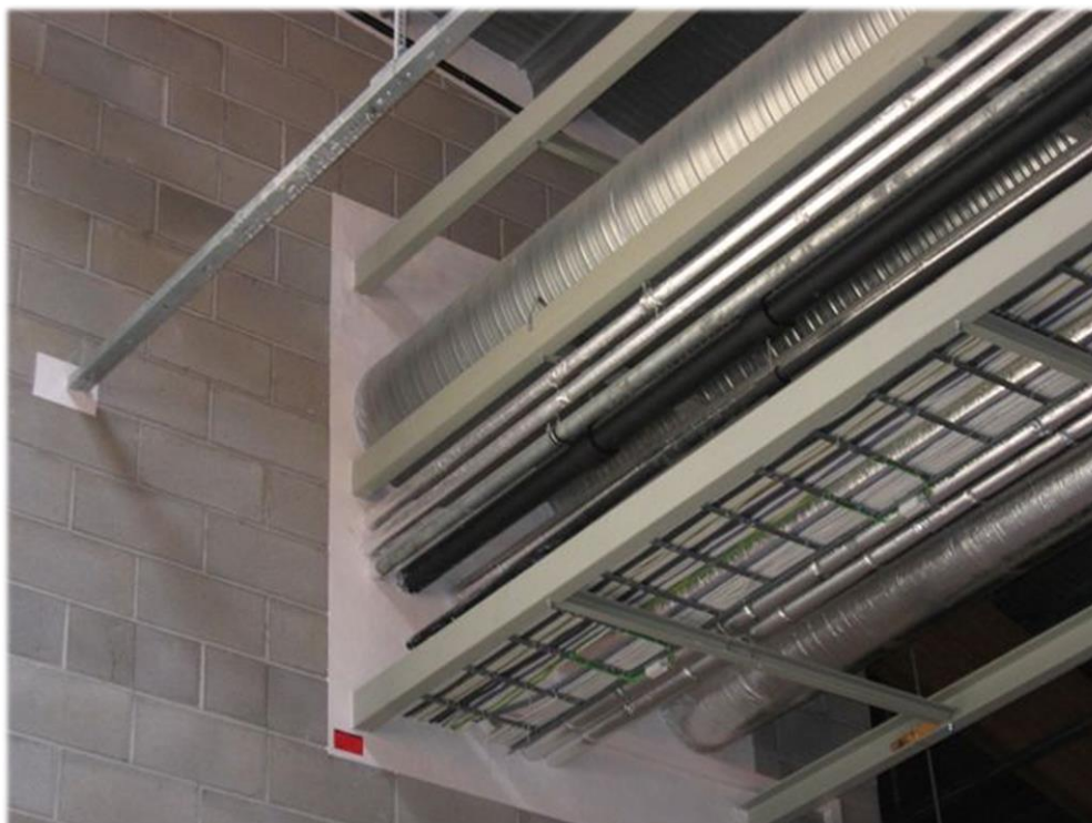
Figur 15 Riktig utført branntetting, (Olstad, 2013)
