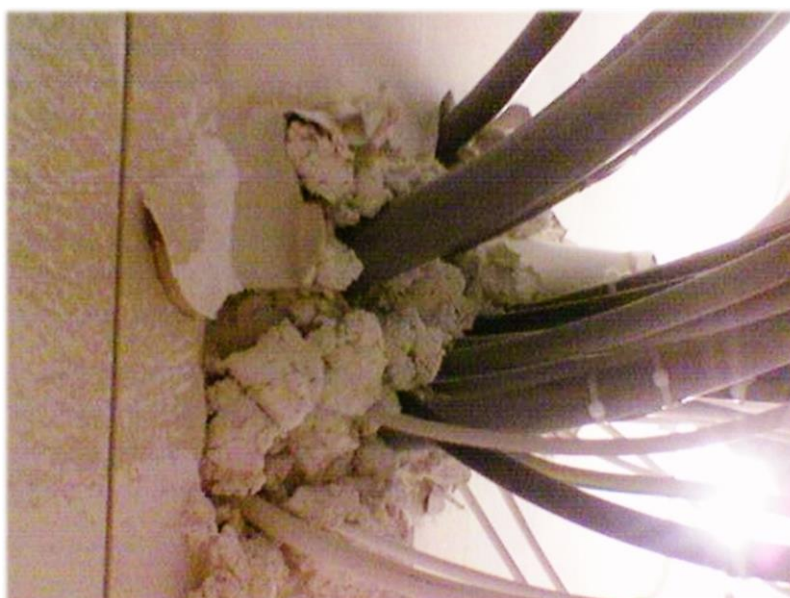
Figur 12 Feil gjennomføring (Olstad, 2013)
