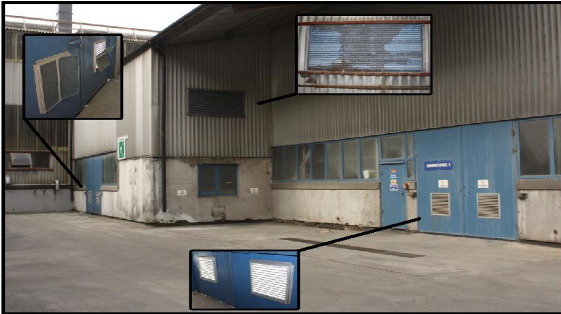
Figur 3-2 viser kompressorstasjon 1 med luftinntakene. (Bilde og redigert: Aasen B.E)
