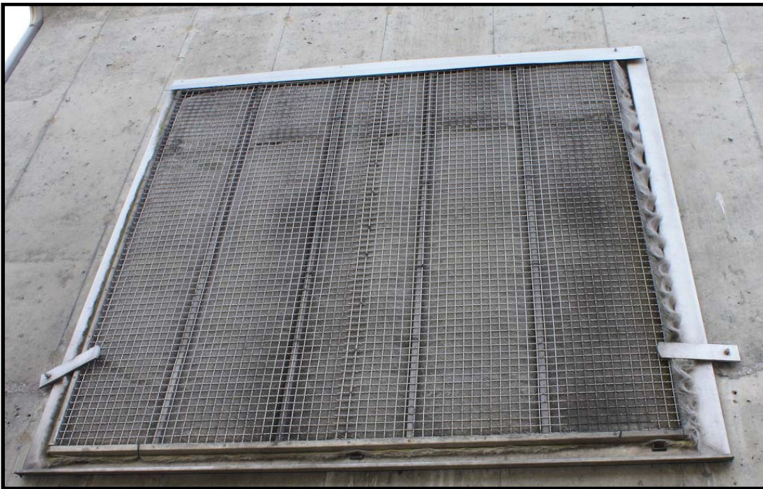
Bilde 2 viser inntak 2 på stasjon 3
