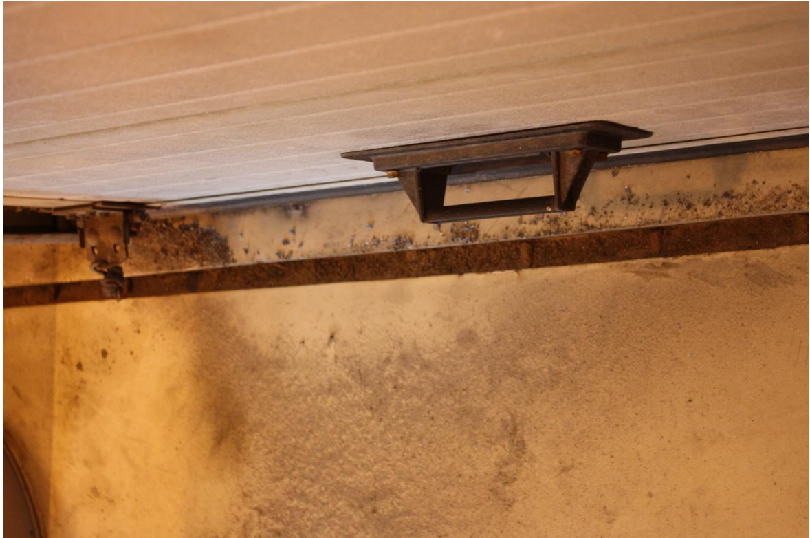
Figur Feil! Det er ingen tekst med den angitte stilen i dokumentet.-1 viser at luften i kompressorstasjon
