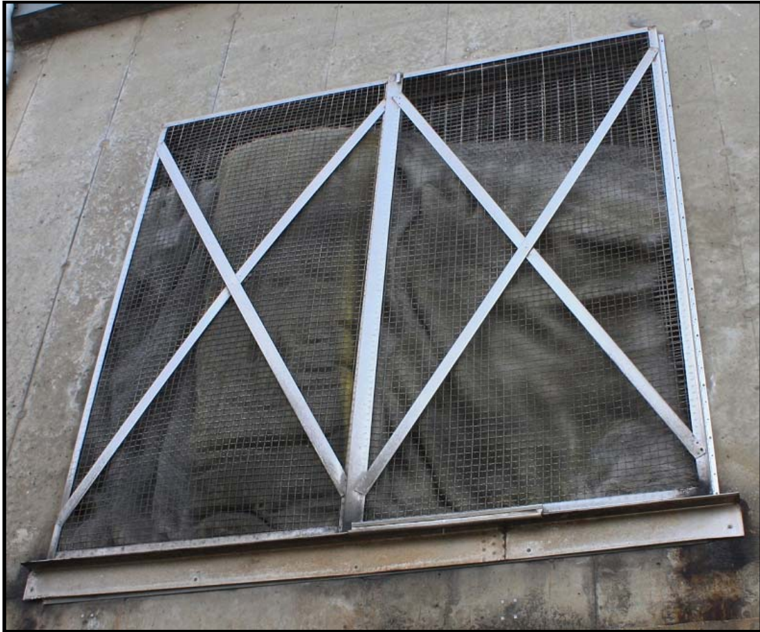
Bilde 1 viser inntak 1 på stasjon 3
