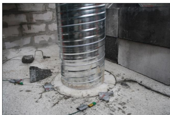
B: Tydelig sprekke og sotbelegg langs fugen i dekket i høyre billedkant. Stopper ved gjennomføringen.
