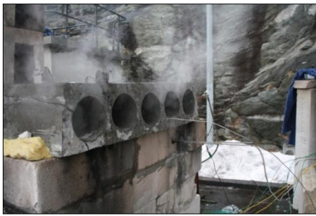
Figur 5-6, Hvit damp fra dekket overside og ut fra kanaler - HD2
