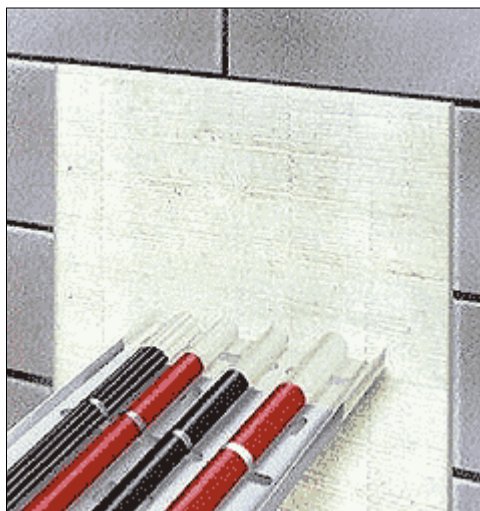
Eksempel på tetting av gjennomføring ved hjelp av brannplate med dekkmaling
