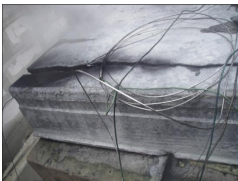
C: Store sprekkdannelse i dekket ved kanal 5. En del røyk gjør at det blir sterk sotdannelse.
