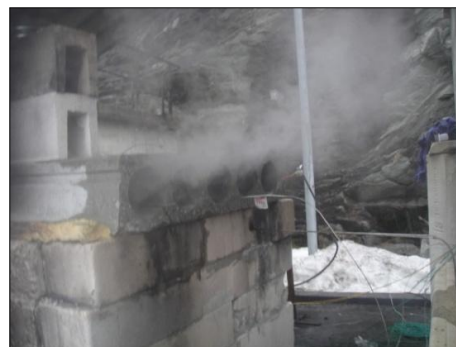
B: Dekket damper, hvit røyk kommer ut av samtlige kanaler
