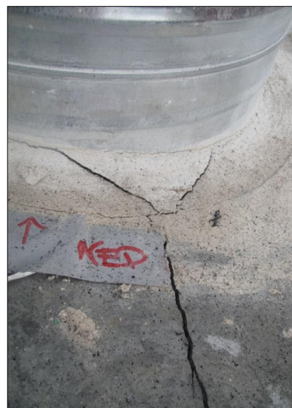
Figur 5-9, Sprekkdannelse langs kanal, ingen tegn til røyk - HD2
