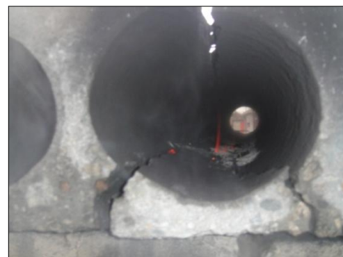
D: Samme kanal fra en annen vinkel viser at røyken tidvis antennes i inne i kanalen.
