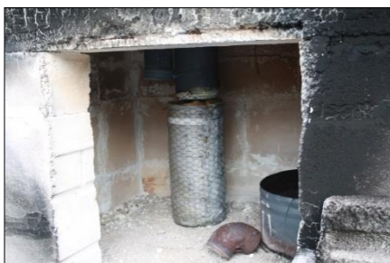
A: Isolasjonen på spirorøret har falt ned under testen. Det har også bend på soilrøret.
