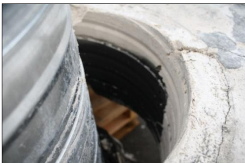
Figur 5-10, Glippe mellom rør og gypsum, Ingen gjennomtrengende røyk - HD2
