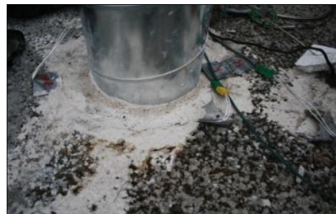
B, C: Vannpytter ligger på oversiden av gipsmassen. Massen virker forøvrig seig og fuktig.
