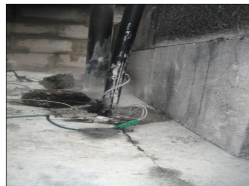
B: Sprekken fortsetter langs kanalen. Gjennomføringer virker upåvirket.
