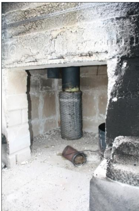
A: Isolasjon på spirorør har falt av. Røret er helt nedsotet, men intakt. Bend på soilrør ligger på gulvet.
