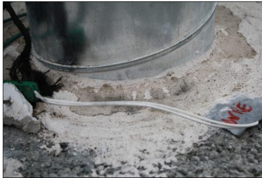
Figur 5-31, Vann på gjennomføringen av gips - LB2
