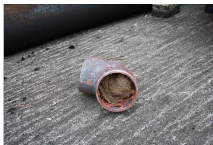
B: Bend var tettet med Rockwool. Røret sto helt åpent når den falt av.
