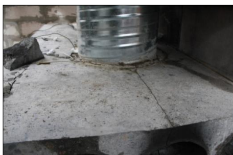
A: Sprekk i langs kanal
