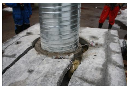
C: Etter endt forsøk ble elementene heist med kran, og elementene sprakk ytterligere. Betongen virker upåvirket av eksponeringen.
