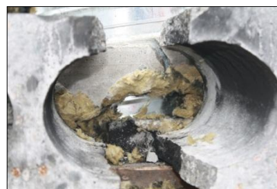
D: Det ble avdekket ulikheter i lagene med løsningen betong-Rockwool-betong. Mellomliggende lag av Rockwool har blitt komprimert under støpeprosessen.
