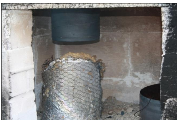
A: Isolasjonen på spirorøret har falt av. Røret er tydelig misfarget men intakt.
