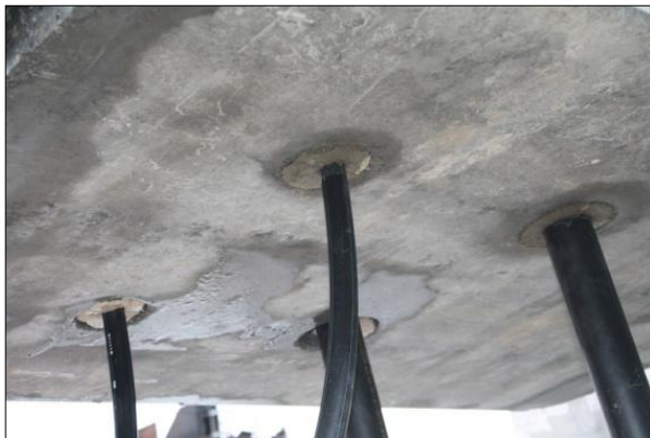
A: Sprekk i gipsens underflate
