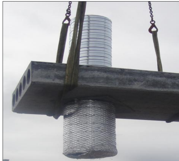
Figur 4-15, Isolasjon på spirorør
