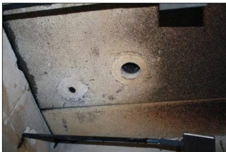
A: Plastrør er smeltet bort.
