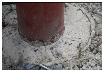
D: Antydning til overfladisk sprekkdannelse i gjennomføring
