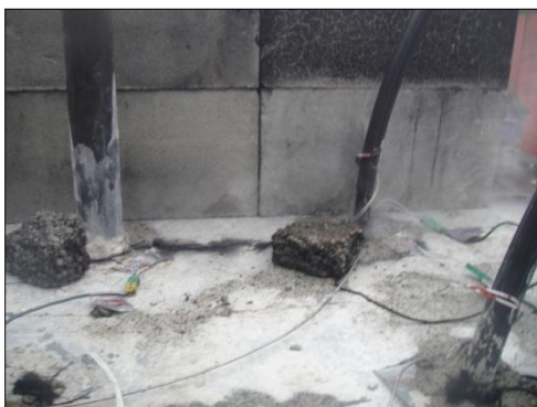
A: Langsgående sprekk mellom gjennomføring i kanal 2 med tendens til sotdannelse. Ingen tegn til brudd i selve gjennomføringene.
