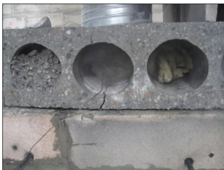
A: Sprekkdannelser på undersiden av kanalen gjør at svart røyk pipler ut ved kanal 3.
