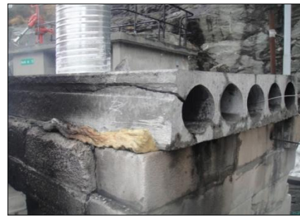
Figur 5-7, Sprekkdannelse langs kanalene i hulldekket - HD2
