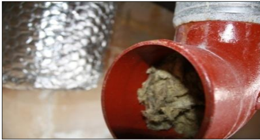
Figur 5-22, Bend på soilrør tett med Rockwool
