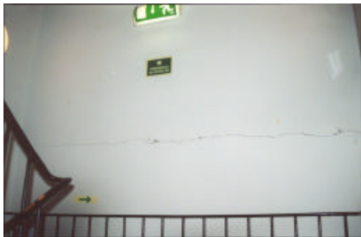
Bilde 1: Sprekker i brannvegg, trapperom.
