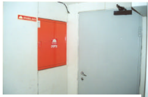
Bilde 7: Ugunstig plassering av brannslange i forhold til korridor.
