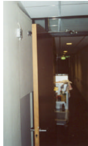
Bilde 4: Manglende lukking av korridorskilledør
