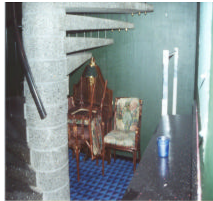
Bilde 2: Rømningsvei brukt som lagringsplass.
