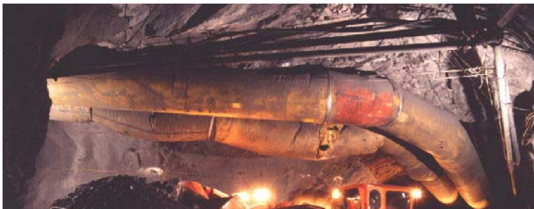
Bild 7 . Pvc-tub som för in tilluft i ort. Normalt går en tub åt varje håll.
