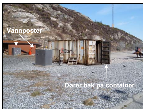
Bilde 3 – Containerens bakside.
