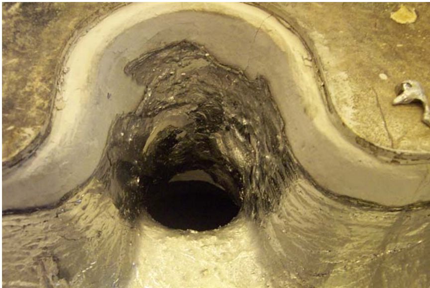
Figur 18. Nedløp til støpeform før vedlikehold. (3)
