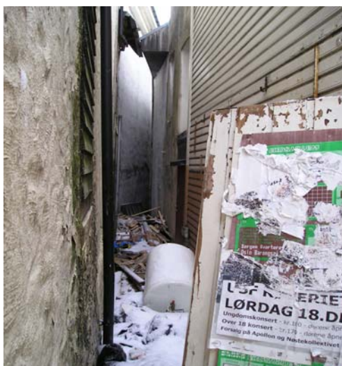
Figur 20: Under befaring av Vågsbunnen ble det observert mye rot mellom mange hus. Hollender gaten 14, viser et eksempel med mye søppel og brannfarlig materialer i tillegg til at det er åpent for allmennheten.
